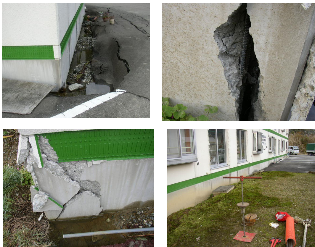
写真 7.35 一般建築物の被害(川口町) 鉄筋コンクリート造の基礎の被害など
