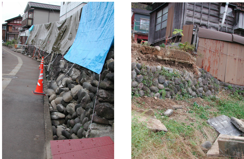
写真 7.21 増積み擁壁等の被害
