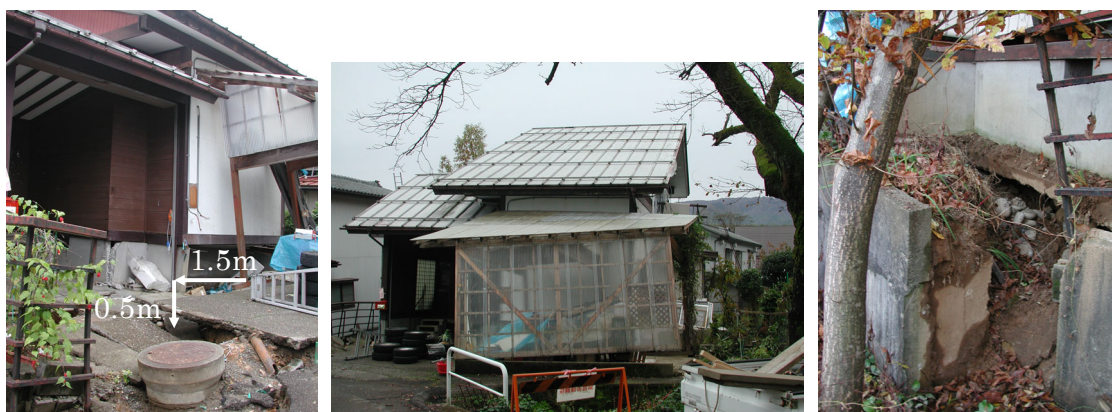
写真 7.7 斜面上部の住宅（A邸）の被害状況
