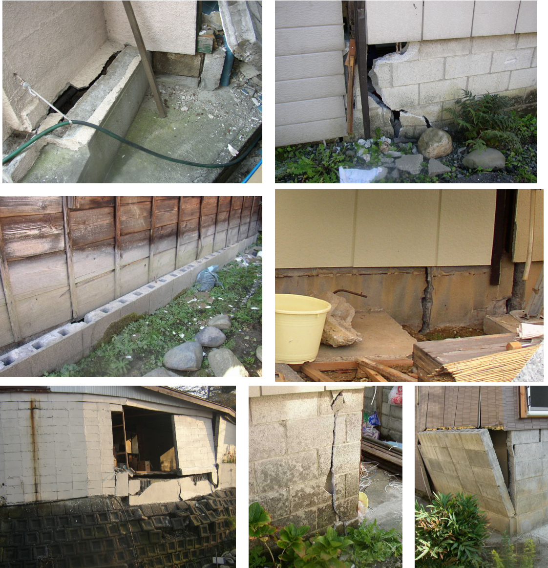
写真 7.31 戸建住宅の基礎の被害例 (ブロック基礎、石積み基礎、無筋コンクリート造基礎など)
