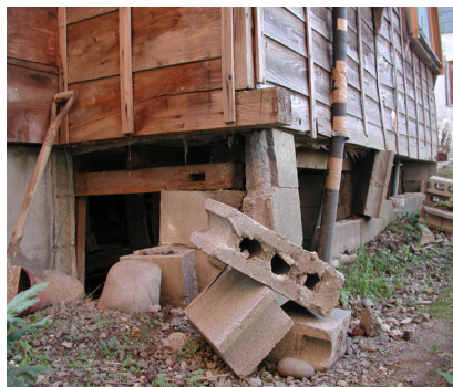
(b) 基礎被害 (外周CB)
