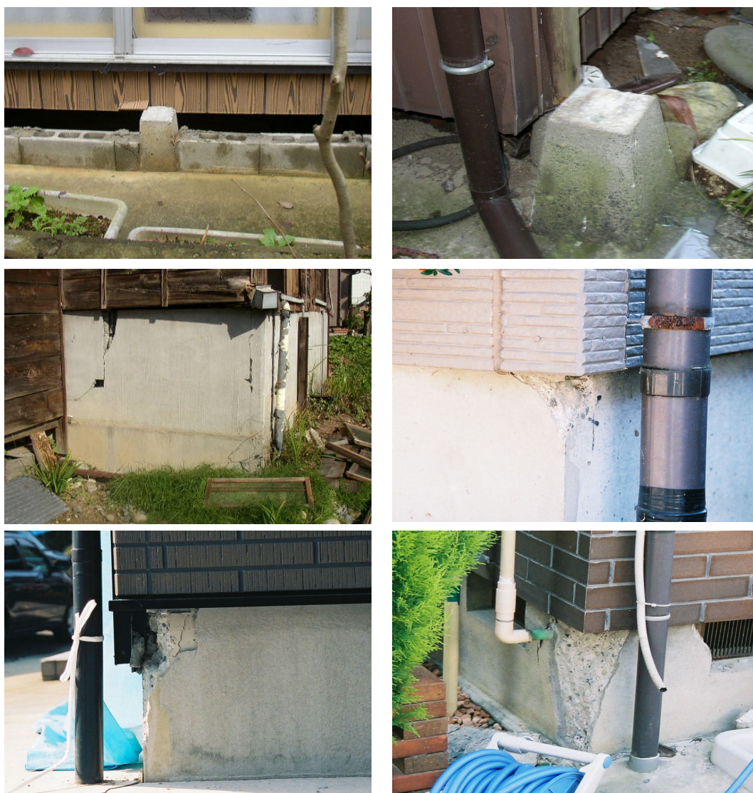
写真 7.6 戸建住宅の基礎の被害状況
