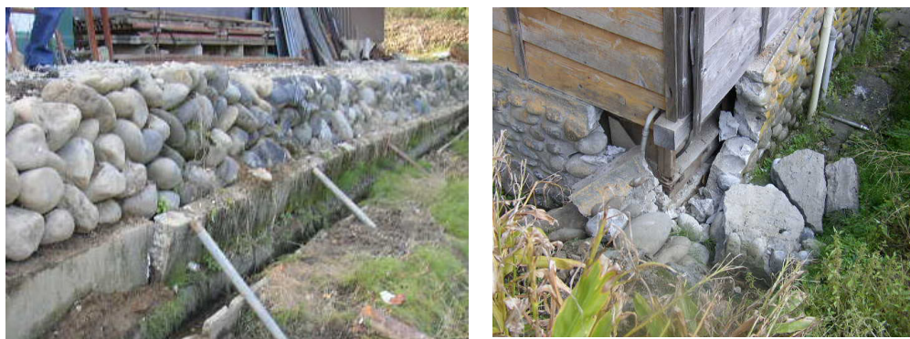
写真 7.17 石積み擁壁・土留めや基礎の被害
