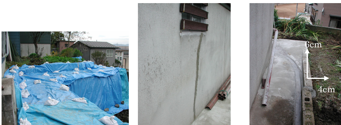
(a) 擁壁被害
