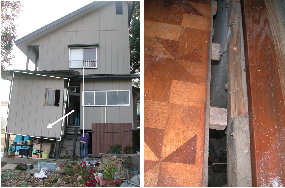
写真 7.18 被害住宅（外観）及び1階床面に生じたずれ（約 15cm）
