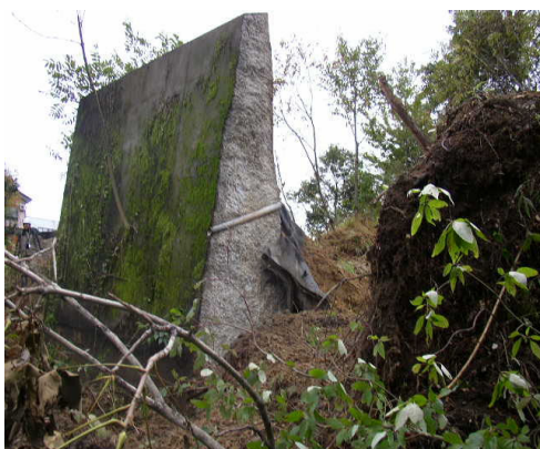
写真 7.23 高町団地の被害状況
