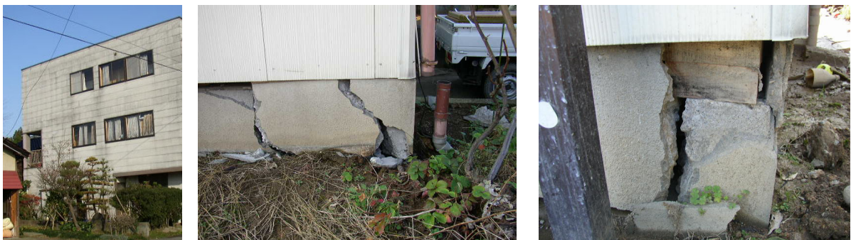
写真 7.22 液状化等による建築物の被害
