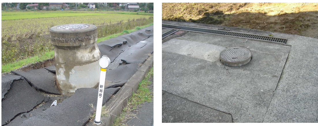
写真 7.5 液状化によるマンホールの浮き上がり
