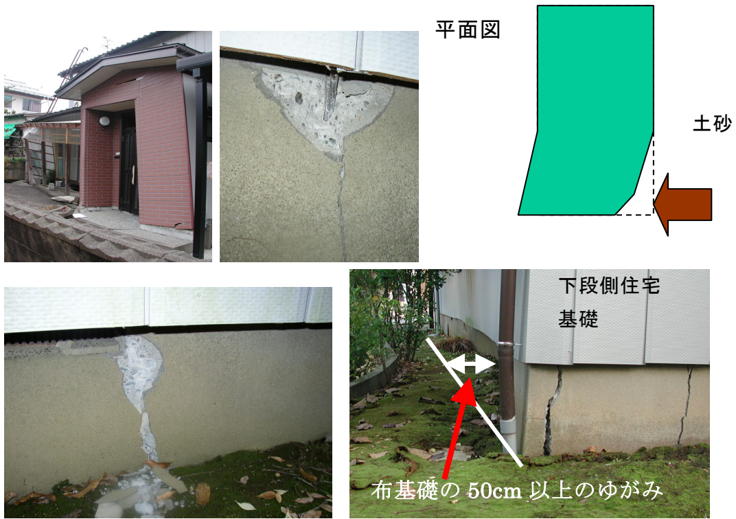
写真 7.8 斜面下部の住宅（B 邸）の被害状況 下段左：布基礎の圧壊
