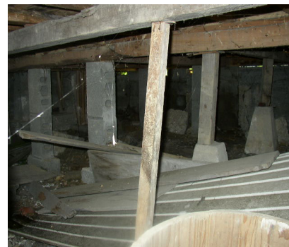
(c) 基礎被害 (内部)
