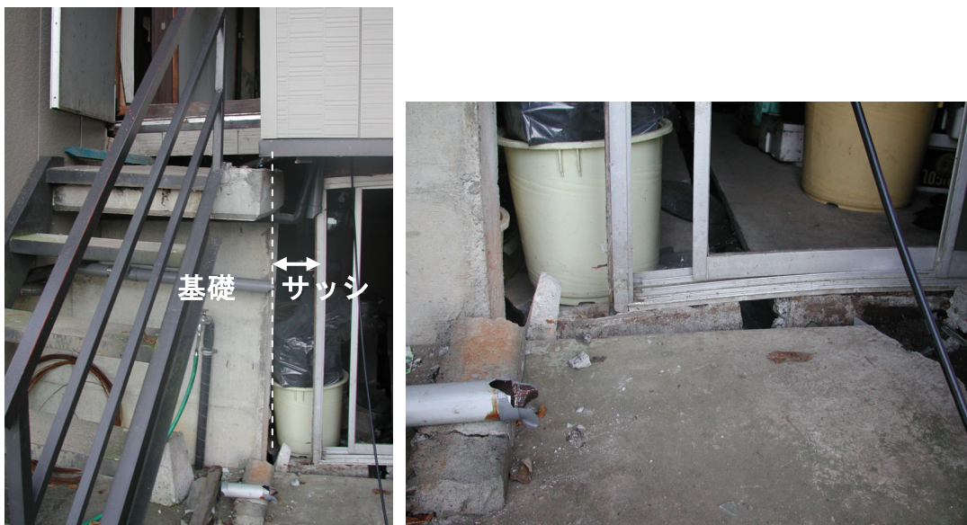
写真 7.19 高基礎の全高にわたり設けられたサッシ及び周辺の段差
