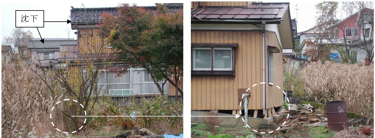
写真 7.9 周囲建築物（C 邸）の沈下被害の例
