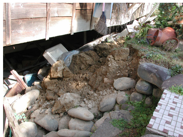
(b) 基礎被害
