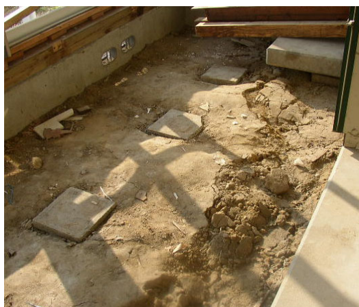
(c) 床下の地盤面の地割れ
