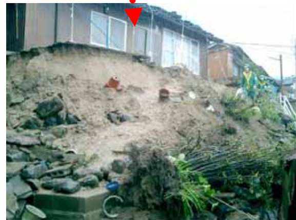
敷地地盤の破壊
