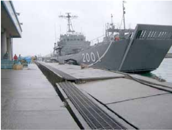
写真 25 海沿いの地盤変状
