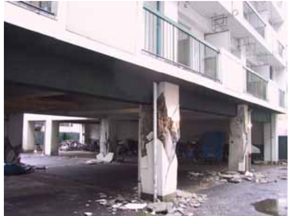
写真11 1階ピロティ柱のせん断破壊
