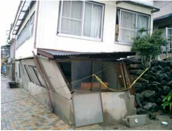
写真 31 後背面の敷地の変状による 1 層に著しい傾き
