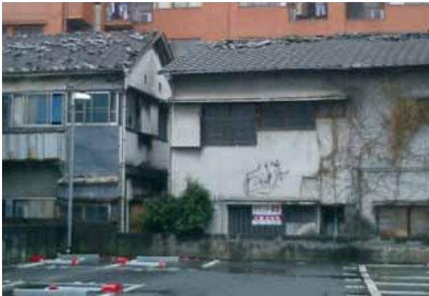
写真 18 瓦屋根の被害
