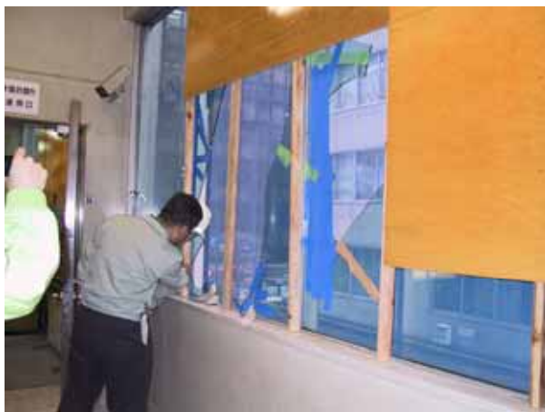
写真1 破損した窓ガラス
