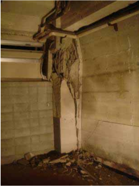
写真 13 1階柱のせん断破壊
