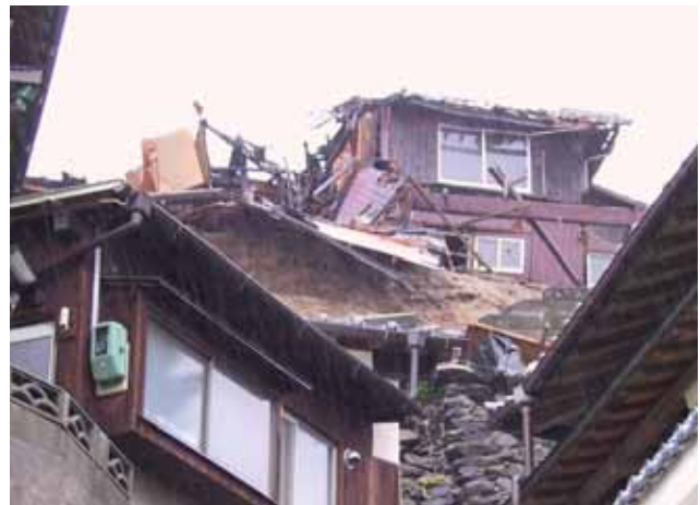
写真 28 敷地と構造の崩壊
