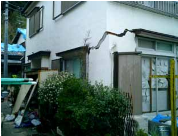
写真 33 外壁のわれ及び障子破れ
