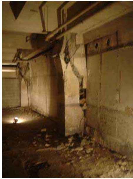
写真 14 1階柱のせん断破壊
