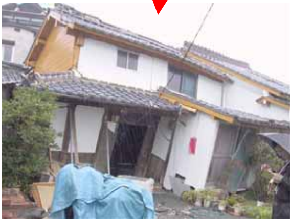
建築物の1階の著しい傾斜
