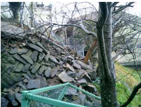
写真 41 小学校南側の斜面の崩壊
