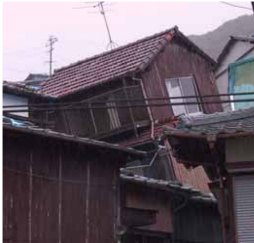
写真 27 全体的に傾いた住宅
