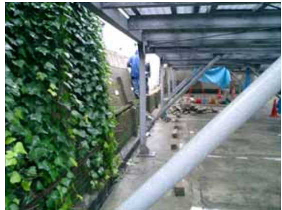
写真 19 駐車場の塀の崩壊
