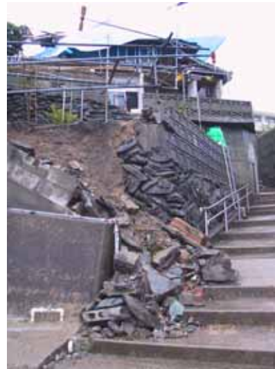
写真 34 石積み擁壁の崩壊
