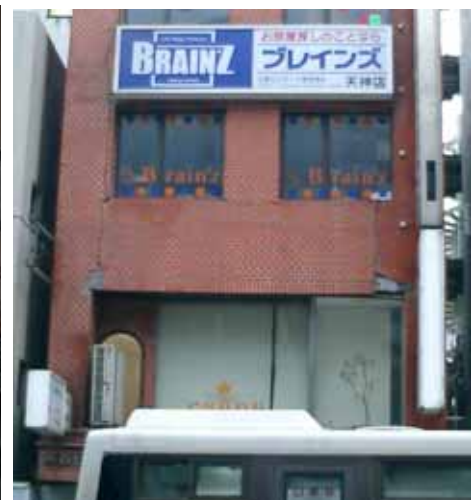
写真 22 外壁のひび割れ・落下
