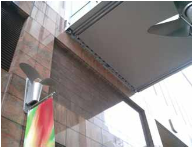
写真 16 エキスパンションジョイントの被害
