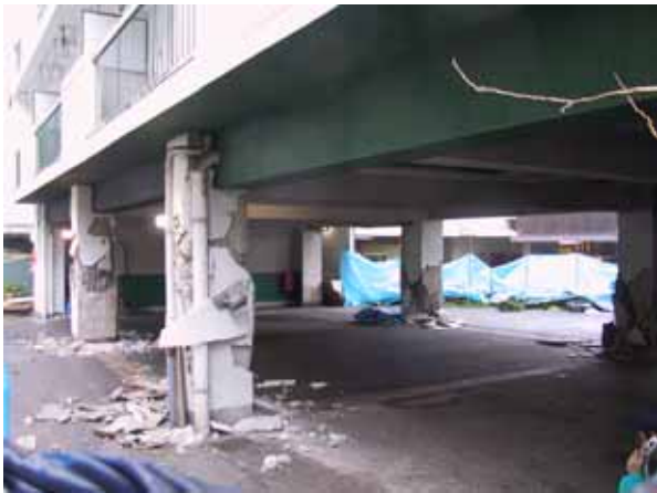
写真10 1階ピロティ柱のせん断破壊
