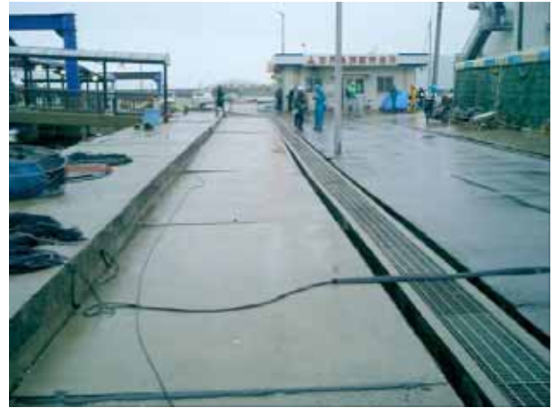
写真 26 海沿いの地盤変状
