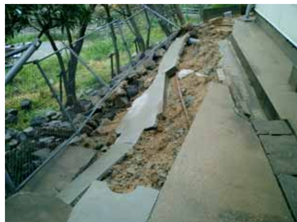
写真 42 小学校南側の斜面の崩壊
