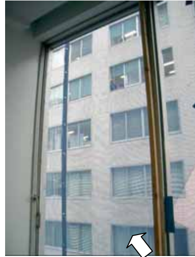
写真6 無被害の可動式窓
