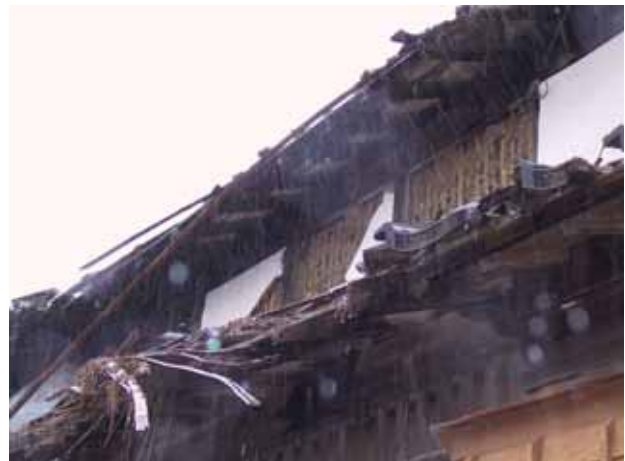
写真 36 土壁及び屋根の損傷
