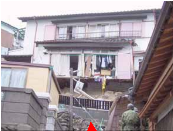
敷地地盤の破壊
