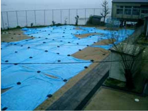
写真 43 小学校校庭 (地割れに雨の浸透を防ぐためのブルーシートと思われる)
