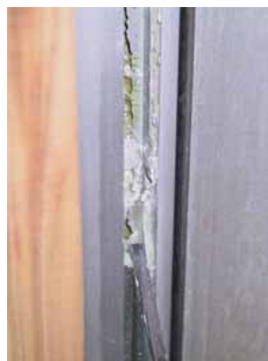
写真4 破損したガラスと硬化性パテ
