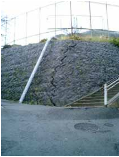
写真 49 中学校の海岸側 (擁壁と道路の割れ)
