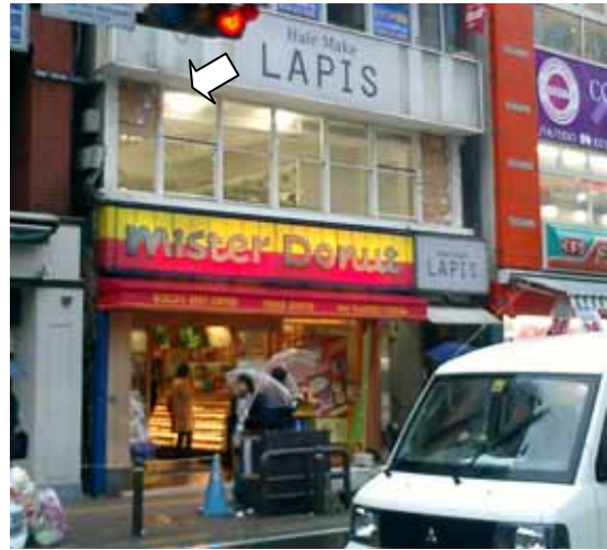
写真 17 窓ガラスの破損
