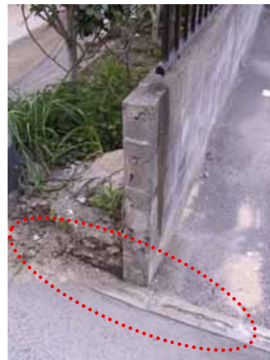
写真8 ブロック塀倒壊箇所
