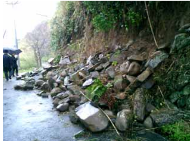
写真 50 東側海岸沿いの石積み擁壁の崩壊
