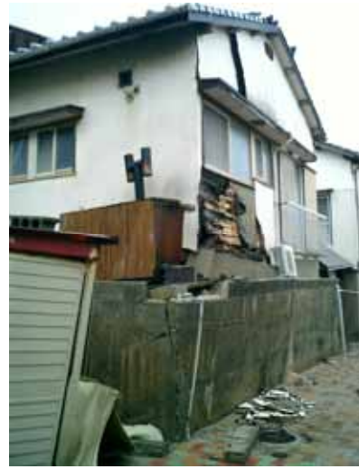
写真 32 擁壁及び外壁の破壊
