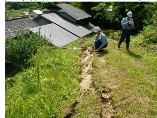
点検で危険度Aと判定された箇所 (宮城県旧鳴子町)
