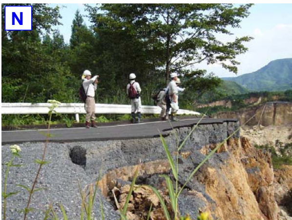
頭部滑落崖の寸断された道路 (H20.8.9撮影)
