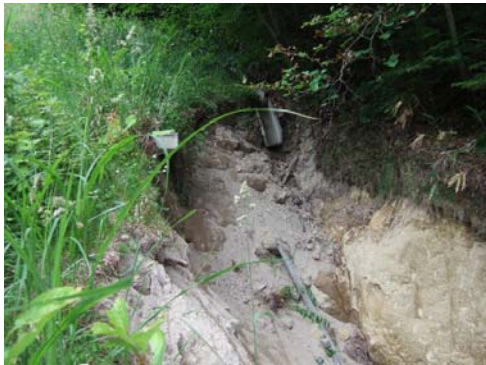
縦排水溝流末の浸食
