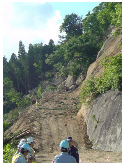
近傍道路斜面の岩盤崩壊
