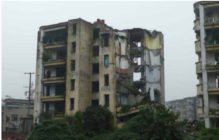
写真 6.3 市街地（都江堰）における枠組組積造集合住宅の被害
