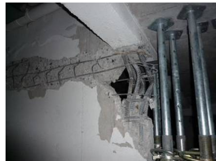
写真 39-2 大破した RC 造壁 （写真 2-3 を再掲）
