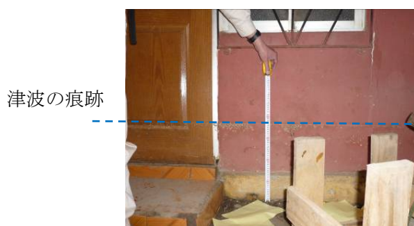
写真 31-1 河口近くの SERVIU 集合住宅の津波跡 (高さ 40cm 程度)
