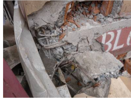
写真 43-2 柱梁接合部の破壊（写真 14-4 を再掲）
