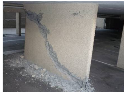
写真 9-4 せん断破壊した壁
