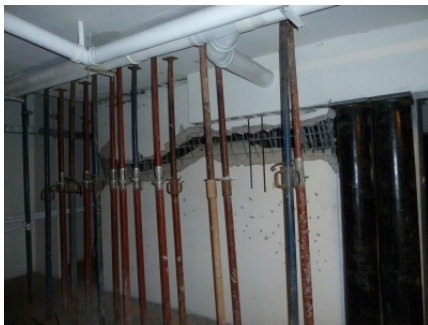
写真 39-1 大破した RC 造壁 （写真 1-2 を再掲）
