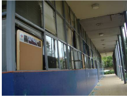
写真 47-1 窓ガラスの飛散(写真 20-2 を再掲)
