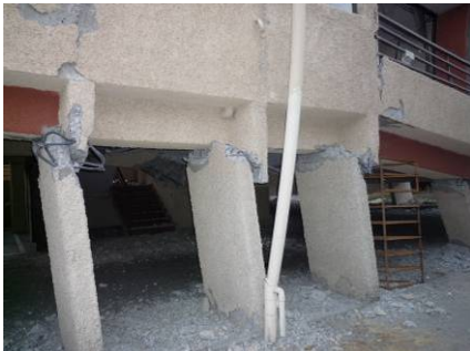
写真 9-3 曲げヒンジが生じた壁柱
