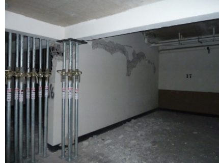
写真 2-2 大破した RC 造壁
