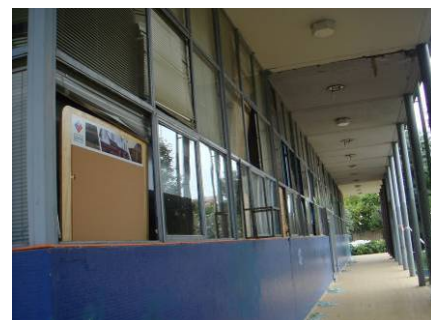
写真 20-2 桁行方向鉄骨柱と窓ガラスの飛散
