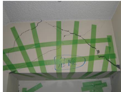
写真 41-2 せん断ひび割れが 発生した短スパン梁 (新潟県中越地震)
