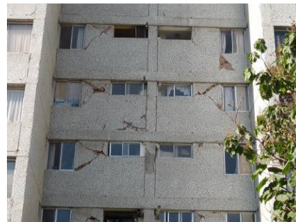
写真 5-2 れんがが積み外壁の損傷
