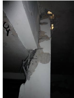
写真 2-4 RC 造柱の破壊
