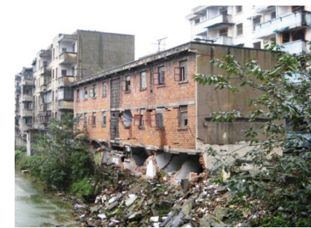
写真 38-3 1階が崩壊したれんが造建物 （四川大地震）
