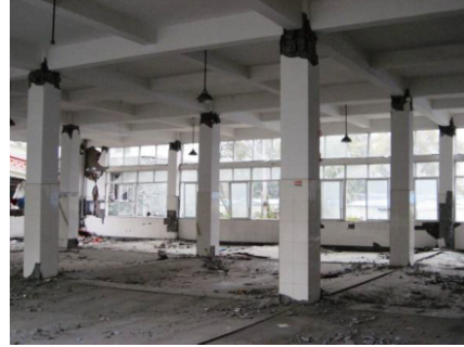
写真 40-2 柱頭の曲げ破壊 (四川大地震)
