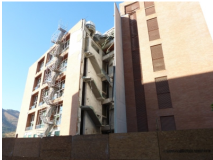
写真 7-1 建物外観 (外部階段の壁が崩落)
