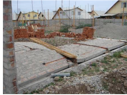
写真 18-4 転倒した組積造壁
