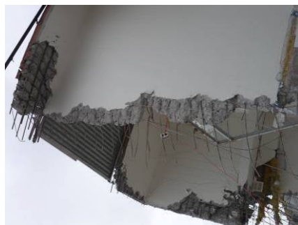
写真 25-2 引きちぎられた 1 階壁柱および耐力壁
