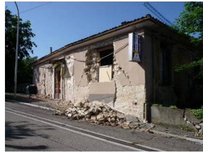
写真 38-4 組積造建物の被害 （ラクイラ地震）
