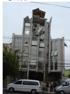
写真 46-3 外壁の脱落 (写真 19-1 を再掲)
