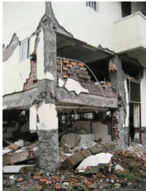
写真 43-3 柱梁接合部の破壊 （四川大地震）
