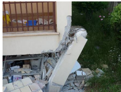
写真 43-4 柱梁接合部の破壊 （ラクイラ地震）
