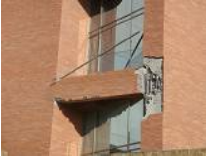
写真 43-1 柱梁接合部の破壊
