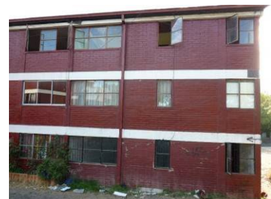
写真 17-2 桁行方向壁のせん断ひび割れ (別棟)
