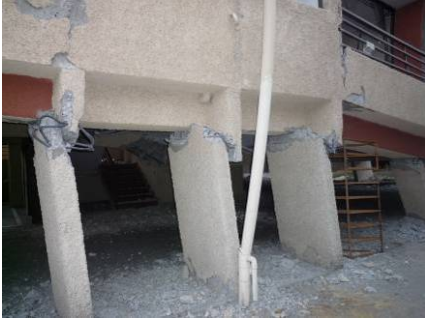
写真 40-1 曲げヒンジが生じた壁柱 (写真 9-3 を再掲)
