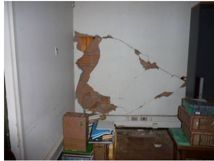
写真 24-2 組積造壁の破壊
