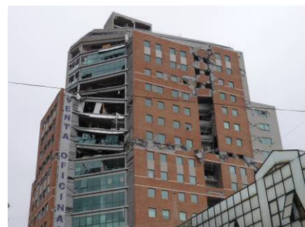
写真35-2 層崩壊した12階付近 (写真23-2を再掲)
