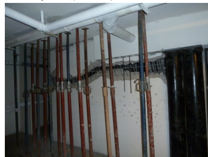
写真1-2 大破したRC造壁
