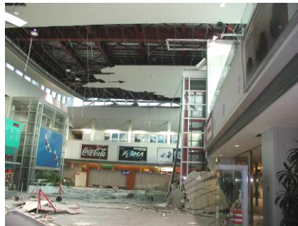
写真 47-3 釧路空港天井パネルの脱落(釧路空港ビル株式会社提供) [7]
