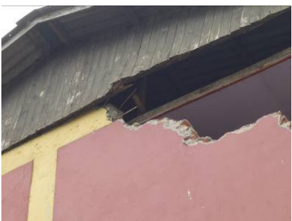
写真 42-1 妻壁頂部の梁の崩落 (写真 15-3 を再掲)
