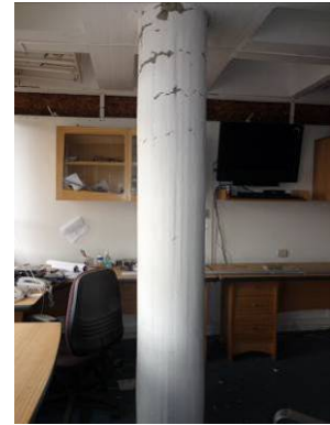
写真 24-3 円柱の曲げせん断ひび割れ
