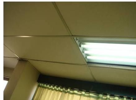
写真 11-3 天井材のずれ
