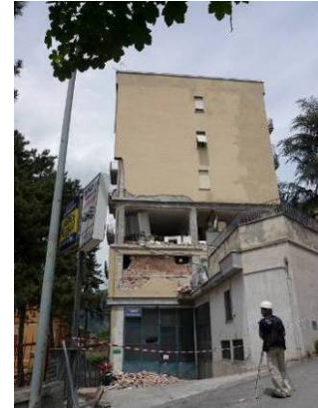
写真 45-3 れんが造壁の破壊 (ラクイラ地震)
