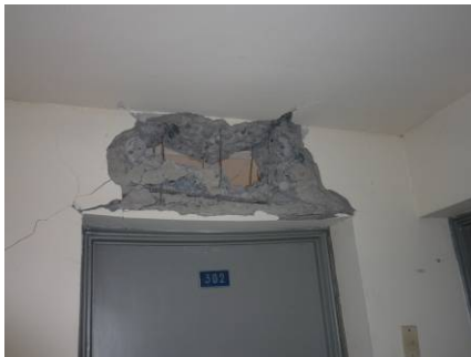
写真 41-1 せん断破壊した短スパン梁 (写真 9-3 を再掲)
