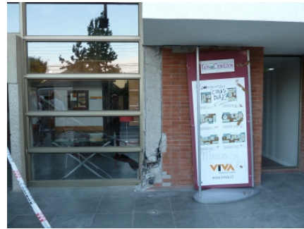
写真 4-2 1階柱脚の圧壊
