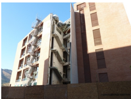
写真 46-2 外壁の脱落 (写真 7-1 を再掲)
