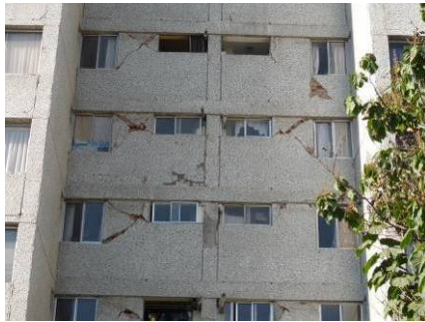
写真 45-1 れんが壁の破壊 (写真 5-2 を再掲)
