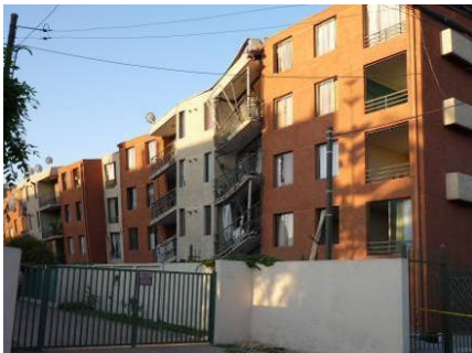
写真 36-1 1層部分の層崩壊 （写真 8-1 を再掲）
