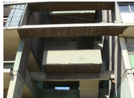
写真 12-4 外部階段踊り場を支える梁のたわみとひび割れ
