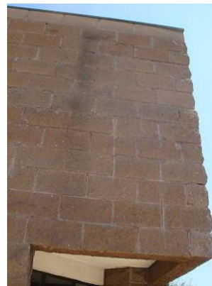
写真 11-2 片持ち壁のひび割れ
