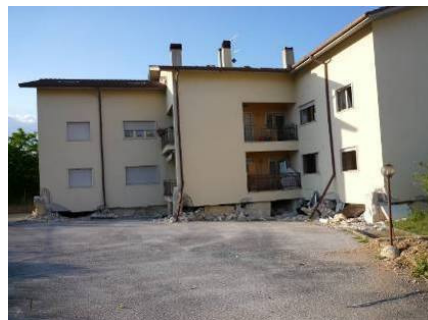
写真 36-4 ピロティ建物の崩壊 （ラクイラ地震）
