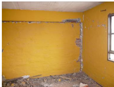
写真 21-2 組積造壁の損傷
