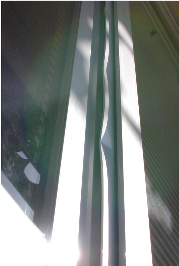
図7 校舎のアルミサッシの被害（取手市内） アルミサッシが雹の衝突によって湾曲している（窓ガラスは新しく入れられていた）
