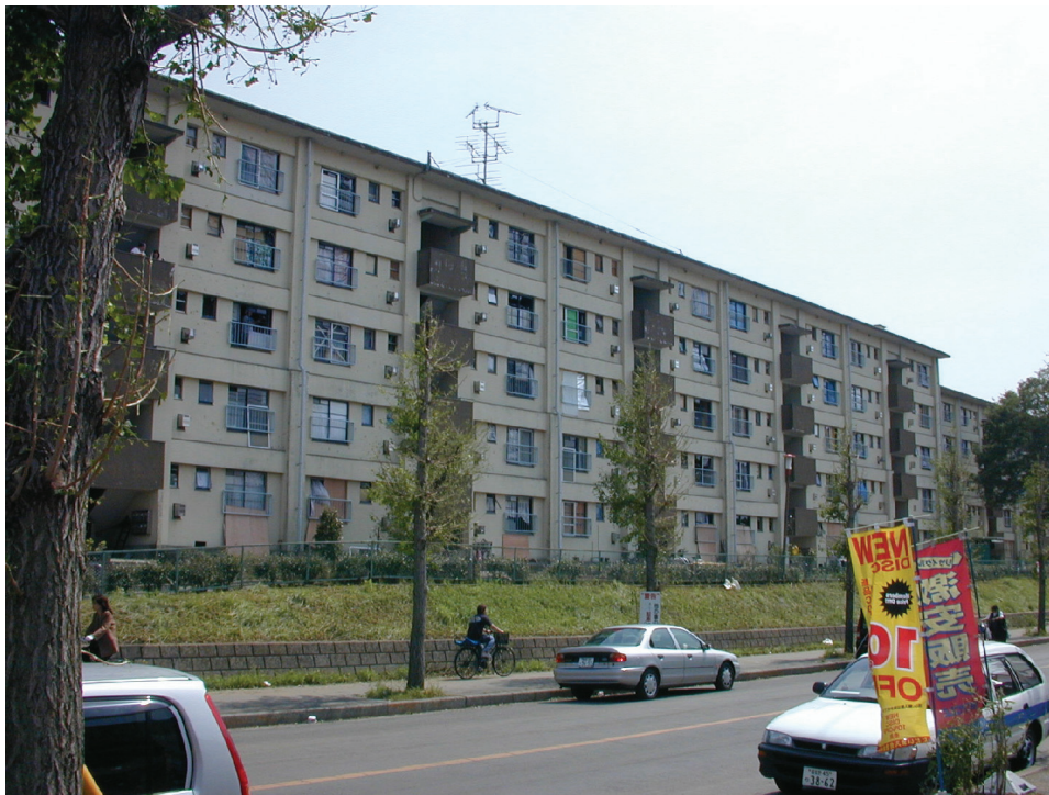
図5 団地北面の被害（我孫子市）被害の2日後に撮影した。
