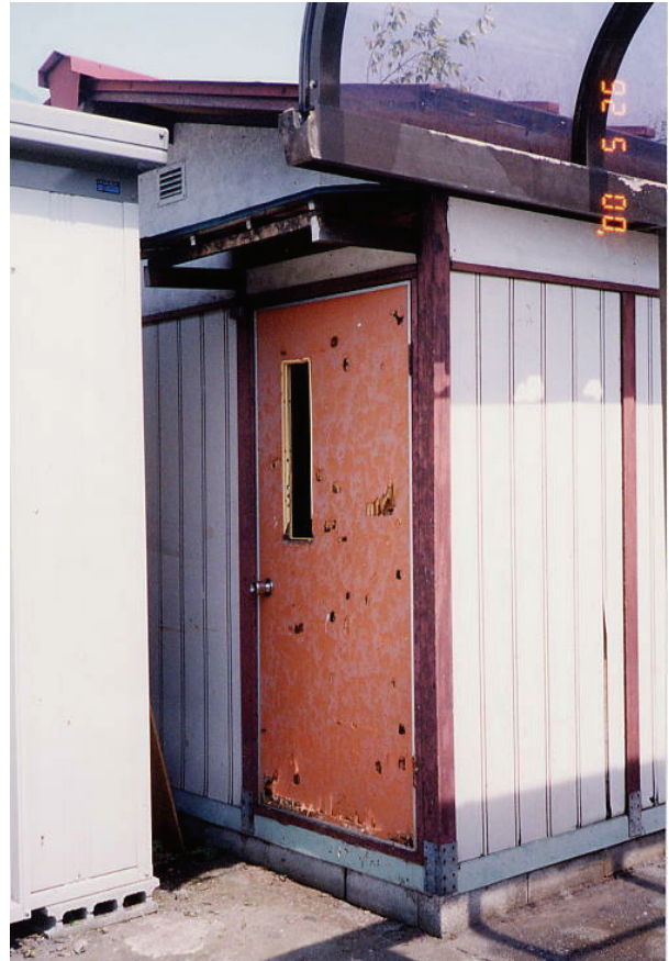
図8 物置扉の被害（我孫子市内） 木製の扉に無数の穴が開いている。中には裏側の板も打ち抜いて貫通しているものもある。
