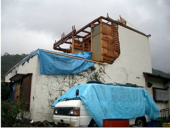
写真7 小屋組及び壁面の被害
