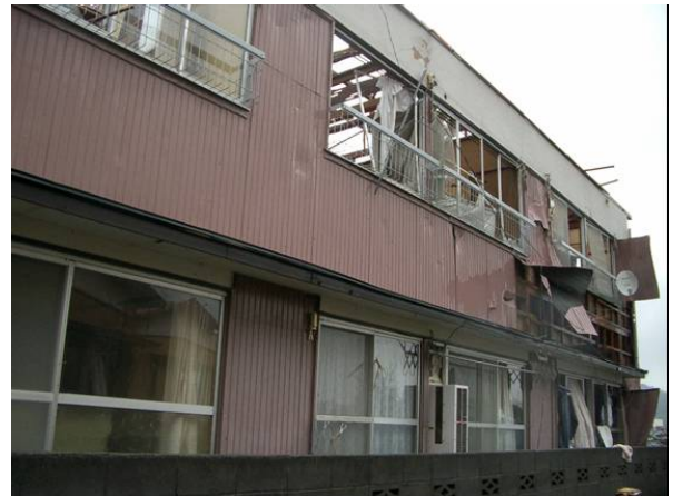
写真10 小屋組及び壁面の被害
