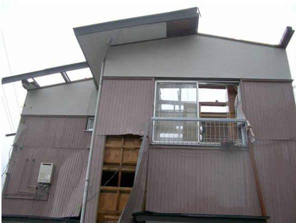
写真9 小屋組及び壁面の被害
