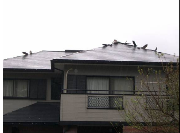
写真4 金属屋根の損傷
