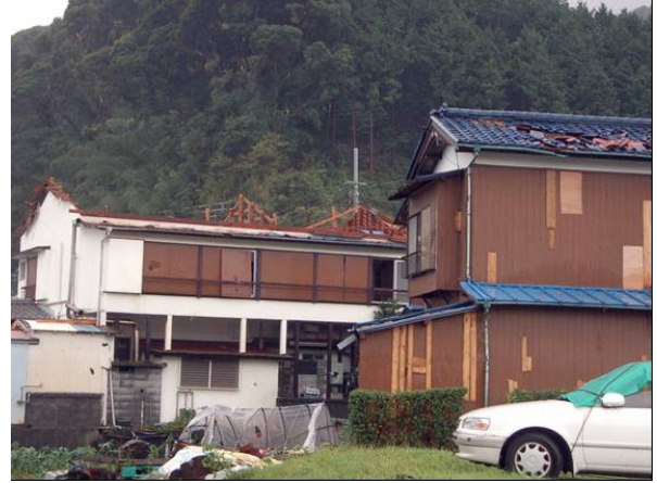
写真8 小屋組の飛散
