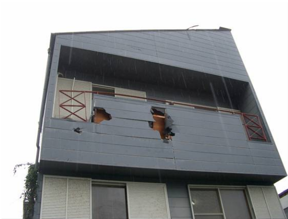
写真5 飛来物による損傷
