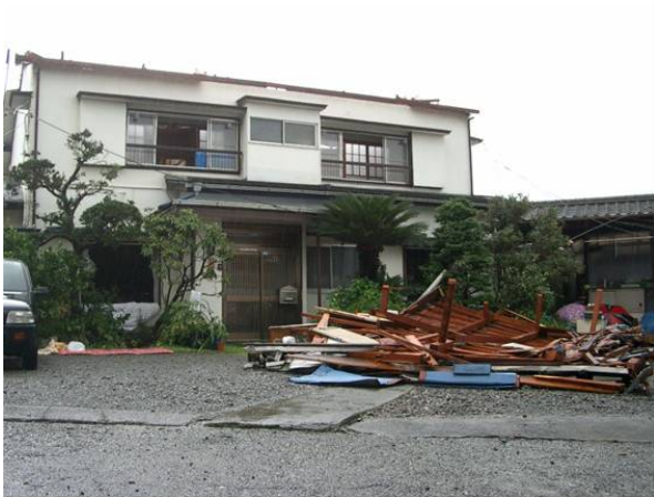
写真11 小屋組の飛散
