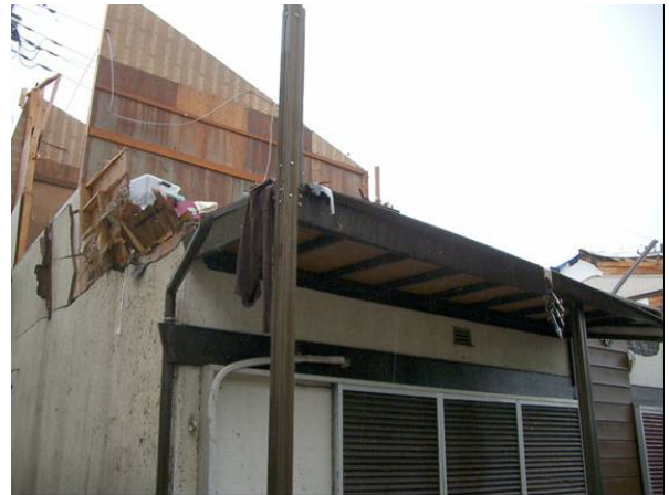
写真12 2階部分の全壊
