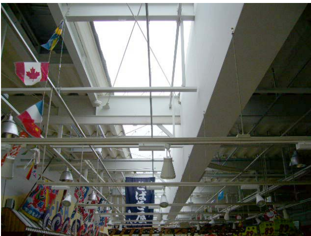
写真9 鋼板製屋根ふき材の飛散
