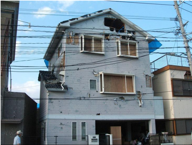
写真 18 住家外壁の被害(中島町)
