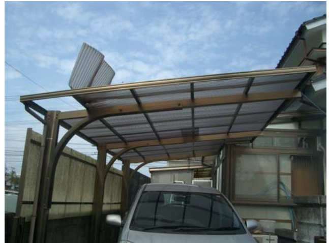
写真 15 カーポート屋根の破損
