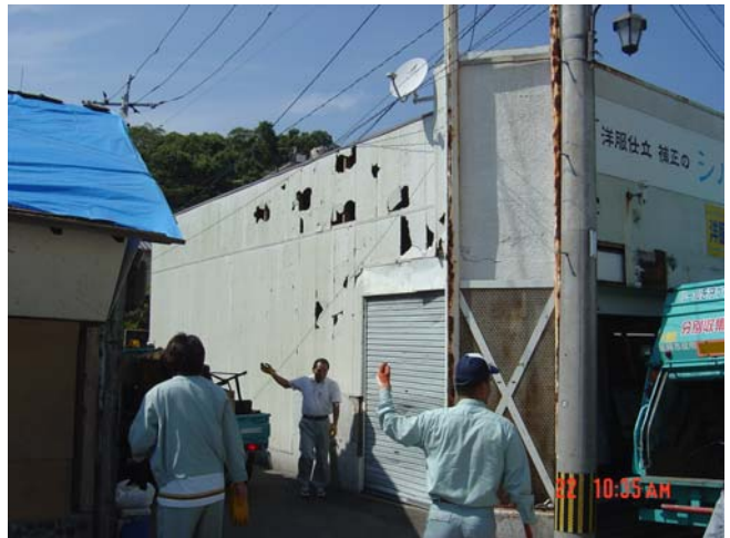
写真 21 店舗外壁の被害(山下町)
