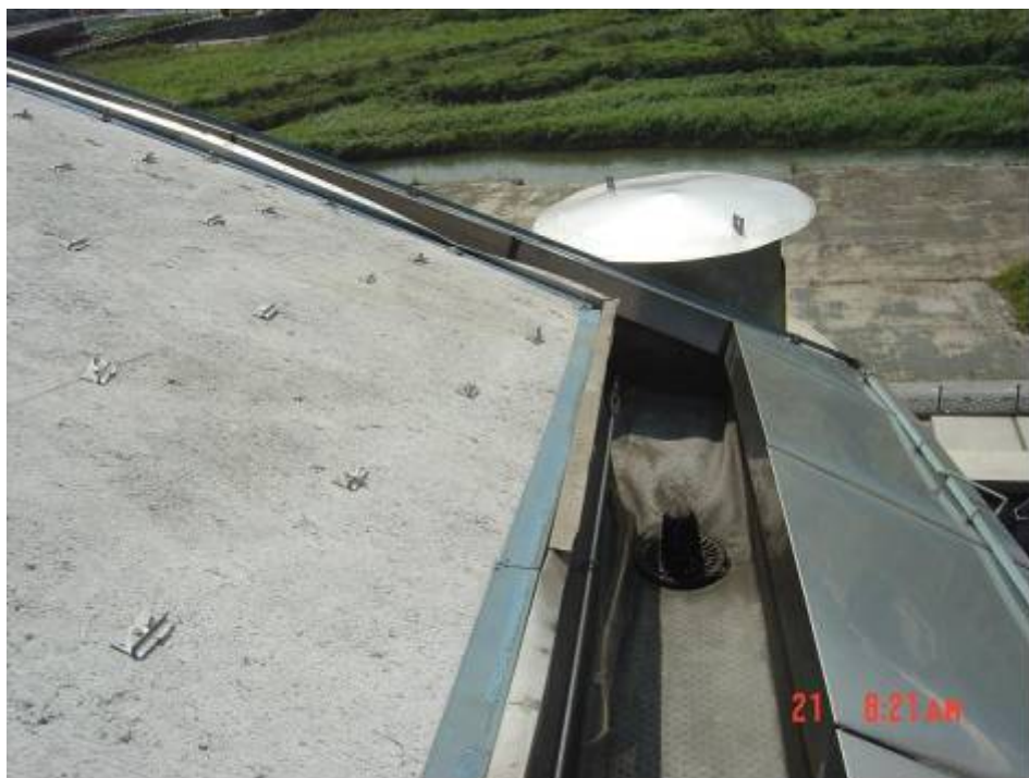
写真 40 屋根の剥離が開始したとみられる隅角部（西南角）の状況
