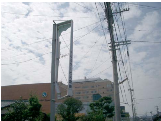
写真 35 看板の損傷(緑ヶ丘)
