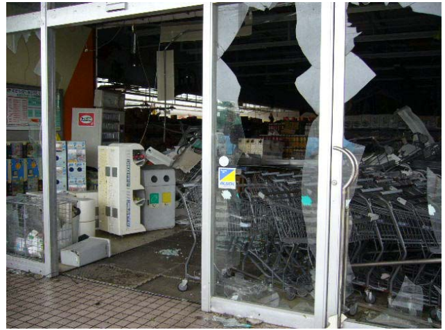
写真8 エントランスの窓ガラスの破損
