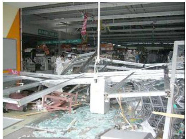
写真6 エントランスのサッシの転倒
