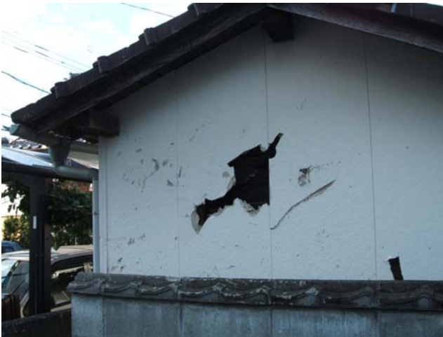
写真 20 住家外壁の被害(緑ヶ丘)
