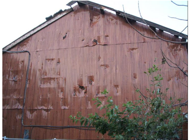
写真 19 住家外壁の被害(山下町)
