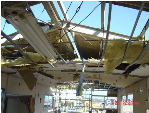
写真 28 屋根ふき材と天井の被害(別府町)
