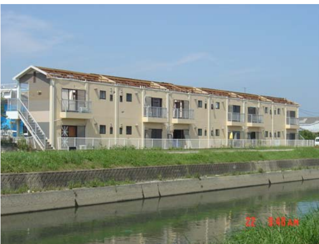
写真 32 屋根ふき材の飛散(浜町)
