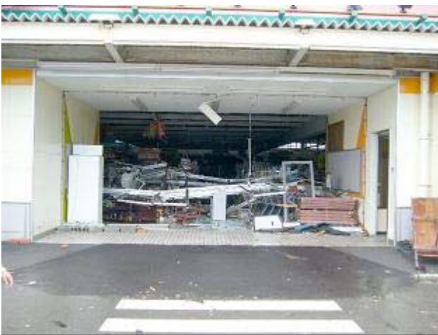
写真5 エントランスのサッシの転倒
