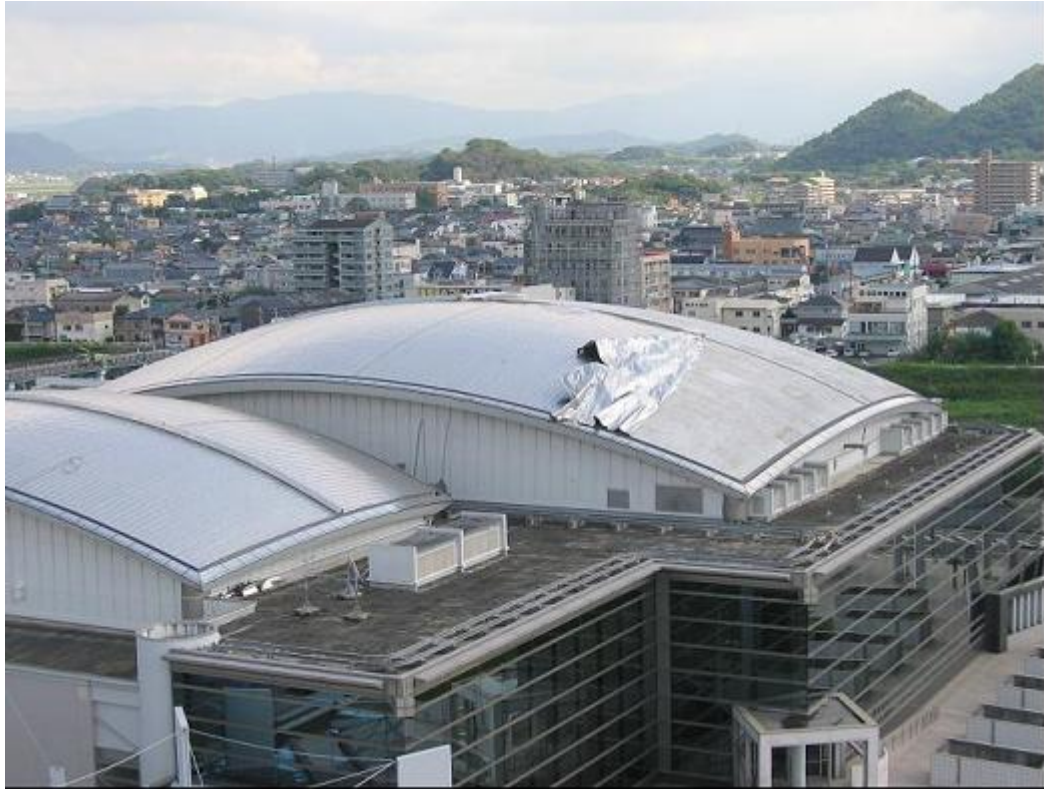
写真 39 ホール鋼板製屋根の被害直後の状況（飯塚市教育文化振興事業団 提供）
