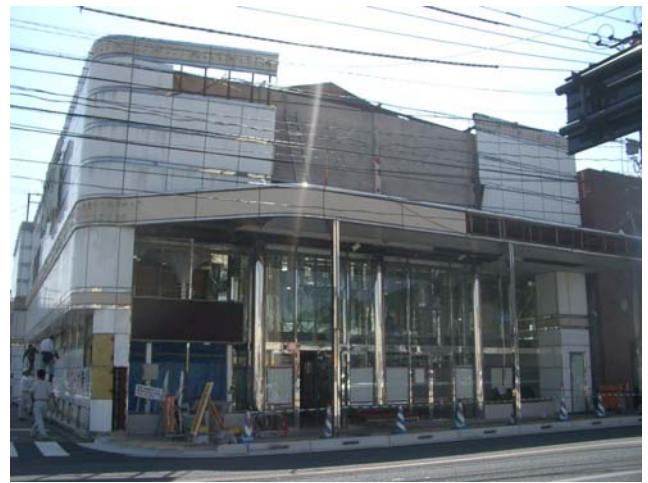
写真 27 店舗外壁のはく離(山下町)
