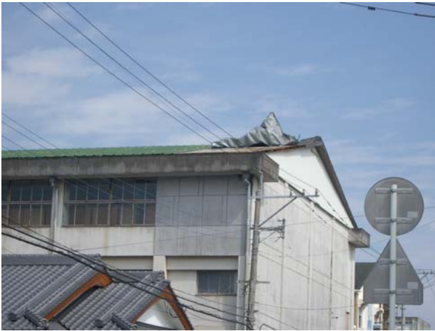
写真 30 体育館屋根ふき材のはく離(緑ヶ丘)
