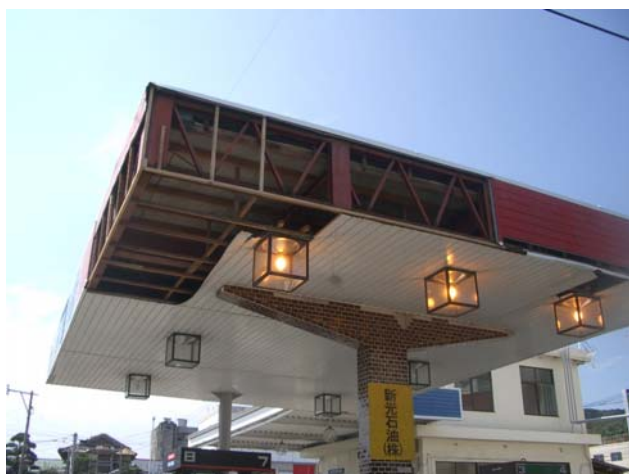
写真 37 ガソリンスタンド屋根の損傷(山下町)
