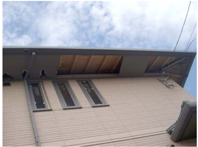
写真 31 住家軒天井の損傷(山下町)
