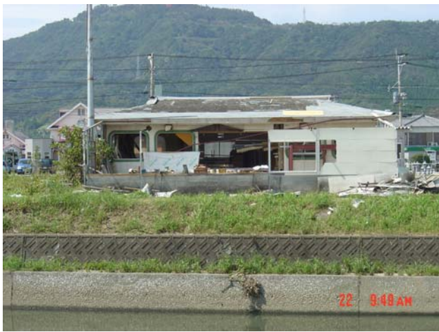
写真 26 店舗外壁及び窓ガラスの損傷(浜町)
