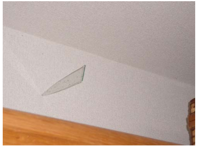
写真 25 破損した窓ガラス片の屋内壁面への突き刺さり (山下町)
