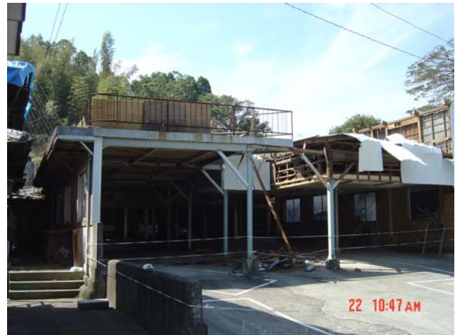
写真 34 デッキ上木造住家の倒壊(山下町)
