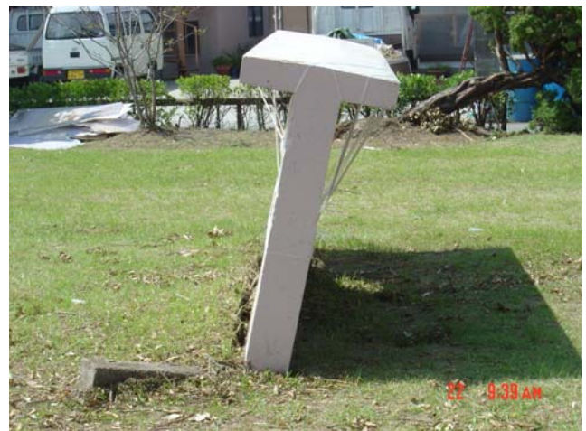
写真 17 RC 造壁の傾斜
