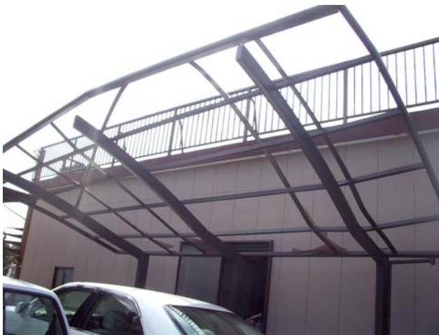
写真 14 カーポート屋根の飛散及び骨組の損傷
