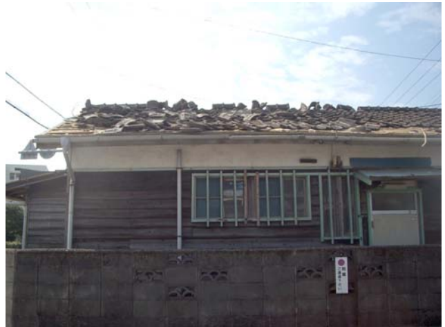
写真 29 瓦の被害(緑ヶ丘)
