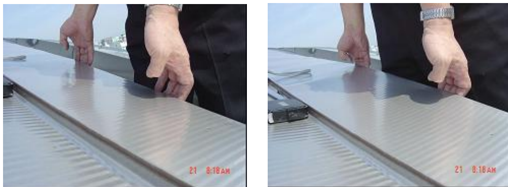
写真49 鋼板製屋根ふき材端部（けらば側）の留め付けの弛み状況
