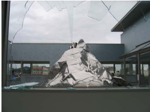
写真 43 隣接建築物に飛んだ屋根ふき材
