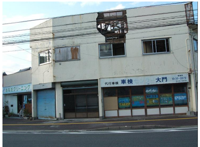
写真 23 店舗外壁のはく離(山下町)
