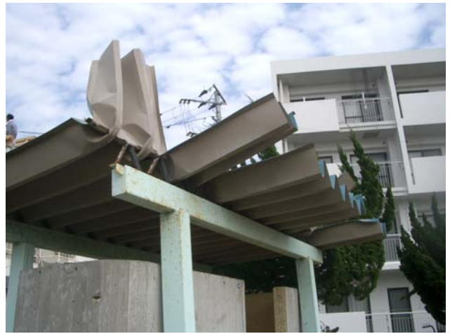
写真 13 屋外トイレ屋根の損傷
