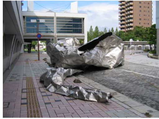
写真 42 落下した屋根ふき材
