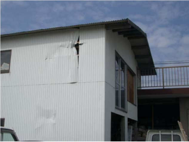
写真 12 倉庫外壁の飛来物痕
