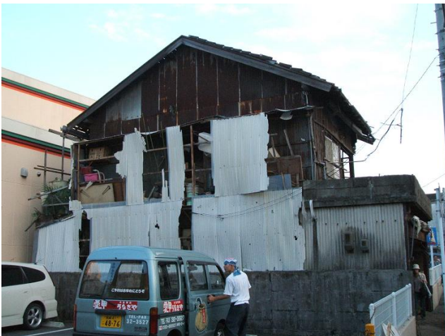
写真 22 住家外壁のはく離(山下町)
