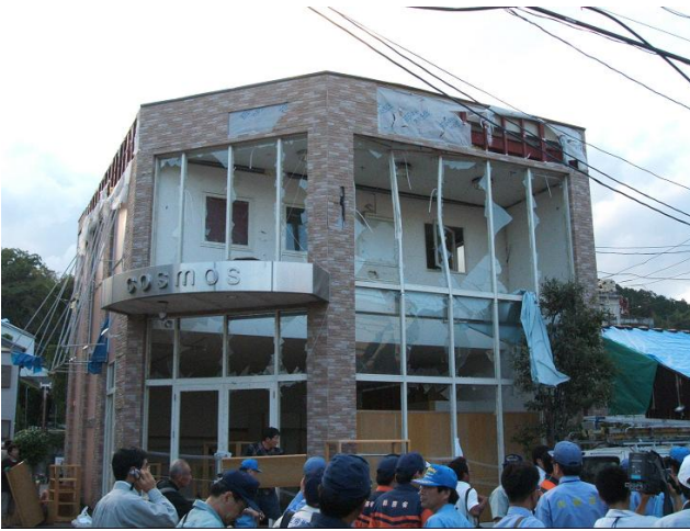
写真 24 S 造店舗外壁のはく離と窓ガラスの破損 (山下町)
