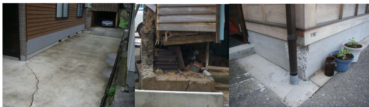
写真-8.6 コンクリート基礎の被害
