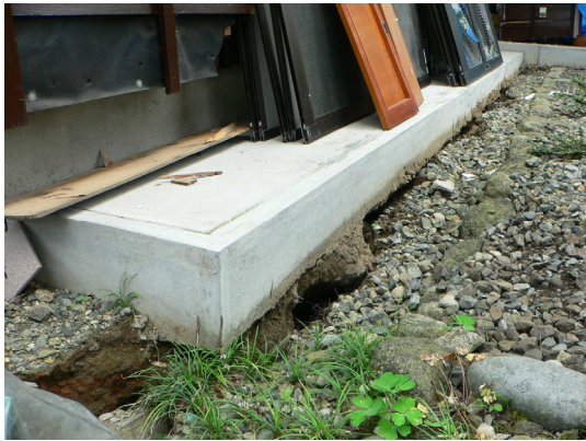
写真-4.3.68 周辺地盤と分離した布基礎
