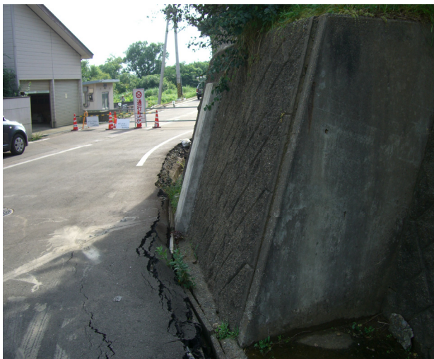
写真-8.6 間知ブロック擁壁の前面側への 滑り出し
