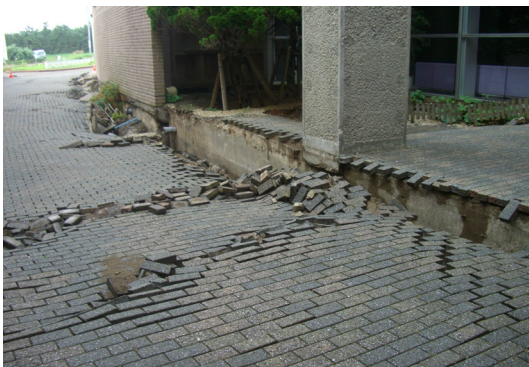
写真-8.30 建物周辺地盤の陥没 杭基礎建物（RC造） 建物周辺の地盤沈下は平均 30cm 程度 （最大 70cm 程度）
