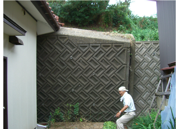
写真-8.5 ブロック積み擁壁の転倒例 地震直後にほぼ鉛直に起き上がり、数日後に転倒状態に達し、背面住宅にもたれかかった例
