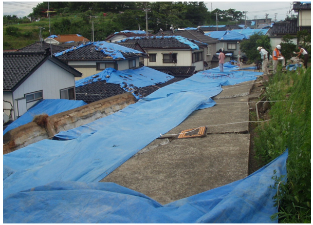
擁壁奥側（高さ 5m）よりの被害状況
