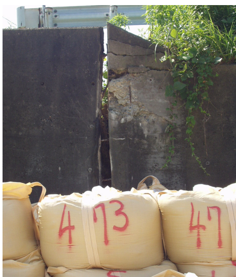
接合部右側の擁壁がはらみ出ている
