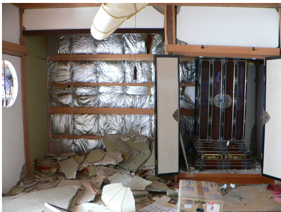
写真-4.3.70 脱落した石こうボード
