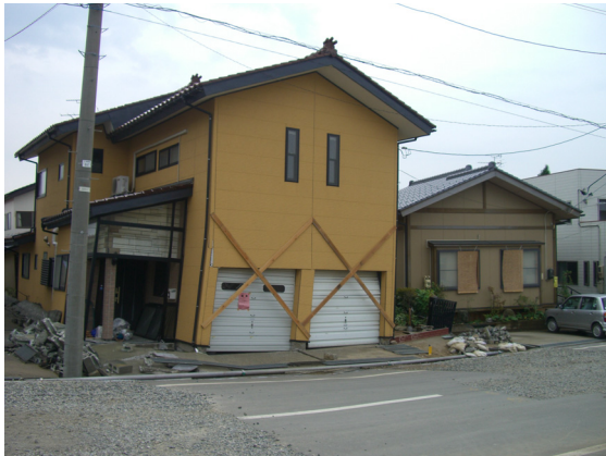
写真-8.1 柏崎市松波地区の液状化被害
