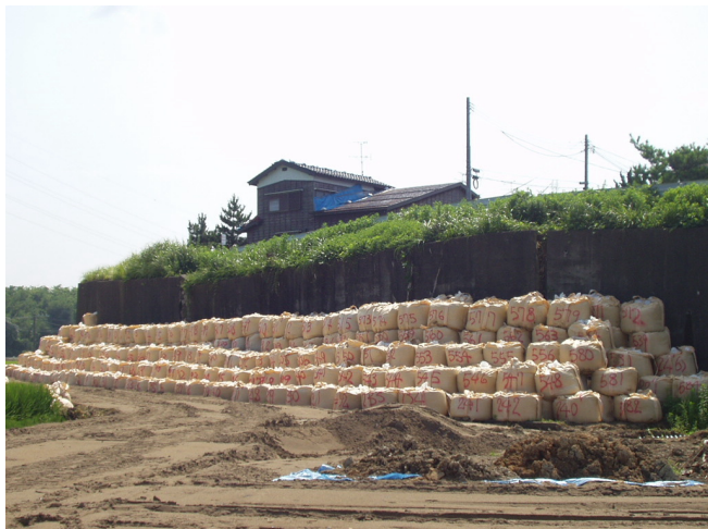
被災状況の全景（応急措置済）
