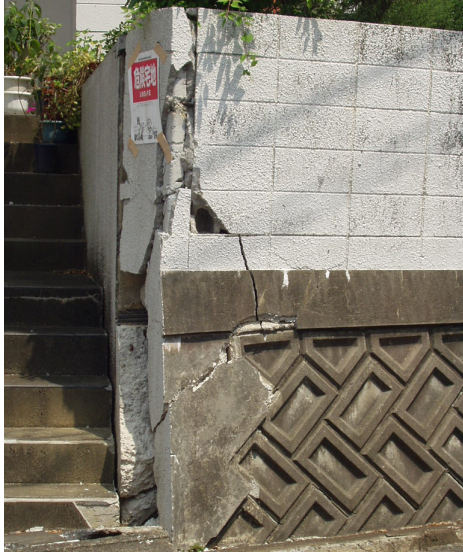
擁壁隅部の破壊
