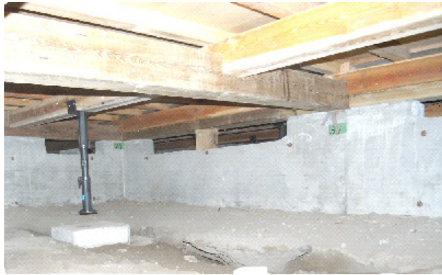
写真-4.3.69 床下（束が浮き上がっている）
