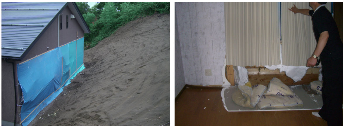
写真-8.13 砂丘斜面の崩壊による住宅の外壁等の破壊例
