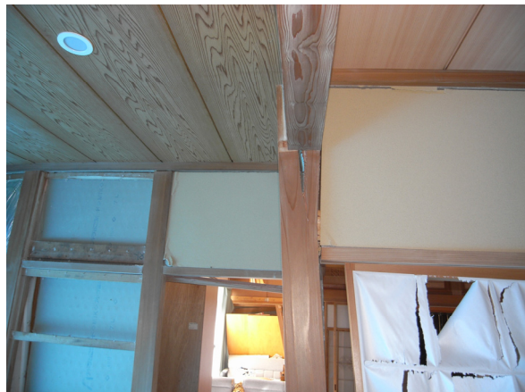
写真-4.3.71 縦に裂けた柱
