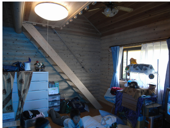
写真-4.3.71 K-3 内部 (1階:被害なし)
