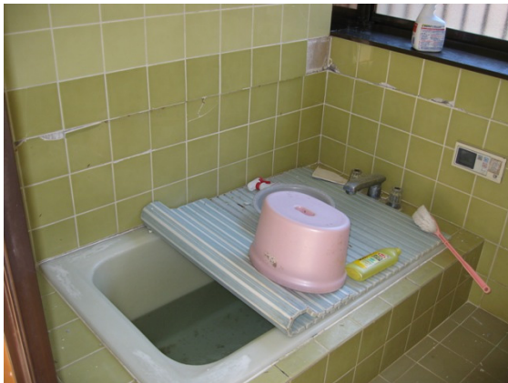
写真-4.3.63 浴室タイル目地亀裂・剥落
