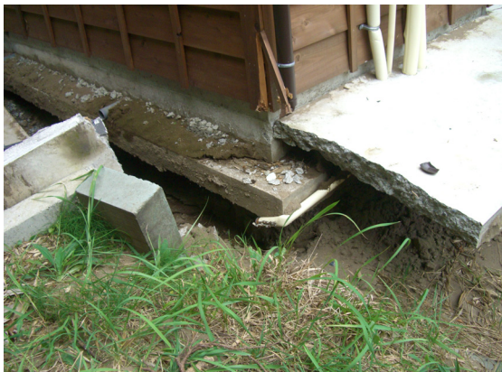
崖側の建物基礎が押し上げられた状況
