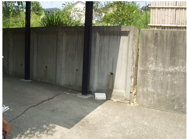
隣地擁壁との間に隙間
