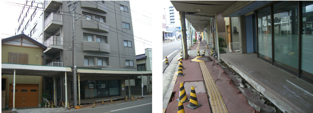
写真-8.24 杭基礎建物の被害（最大 500 程度の建物の相対的な浮き上がり）
