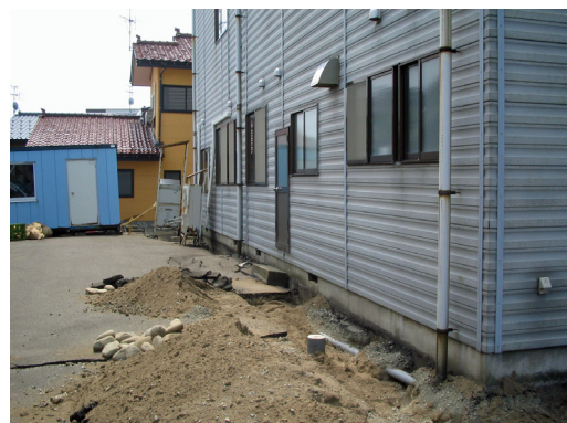
写真-8.31 鉄骨造 2 階の建物の不同沈下 （基礎形式：直接基礎、数十 cm の不同沈下）
