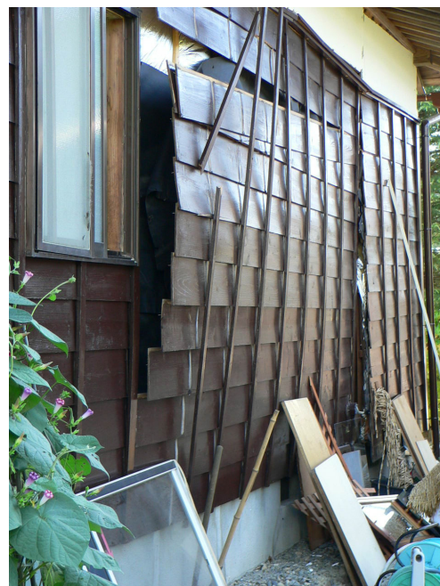
写真-4.3.67 座屈した筋かいにより押出された外装材
