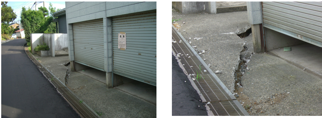
写真-8.22 日吉小学校周辺の道路沿いで生じた段差による住宅の沈下障害による被害例
