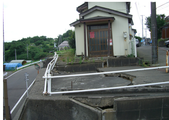
写真-8.9 山側の被害宅地の状況 (擁壁背面地盤の沈下・変形)
