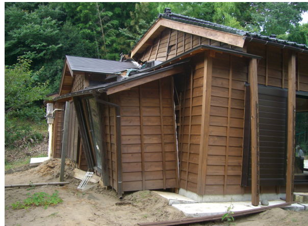
写真-8.2 刈羽村の液状化等に起因する地盤変動による新築住宅の被害
