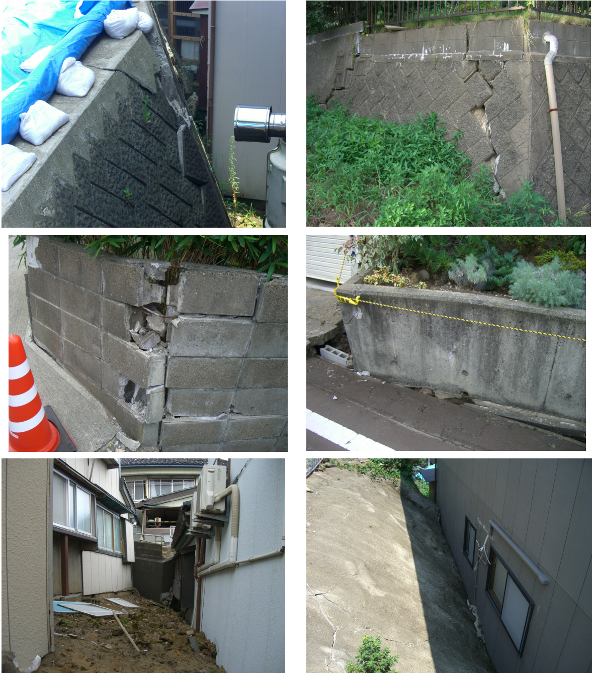
写真-8.33 種々の擁壁の被害例
