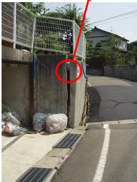
コンクリート擁壁のはらみ
