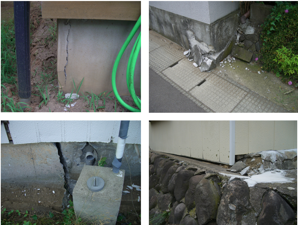
写真-8.28 基礎構造の被害例 (コーナー部に集中しやすい被害)
