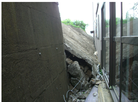
写真-8.11 モルタル吹き付け壁面の崩壊
