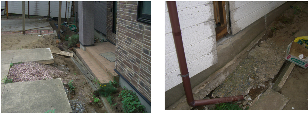
写真-8.20 宅地内の地盤の陥没や水平変位による住宅の被害
