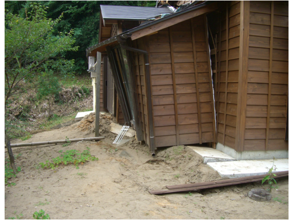
被災住宅 崖面側
