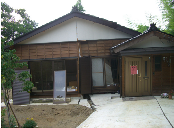
被災住宅 前面
