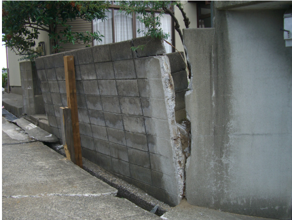
写真-8.4 ブロック塀による土留め擁壁の崩壊
