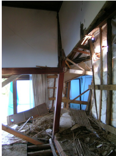
写真-4.3.58 柱折損の詳細
