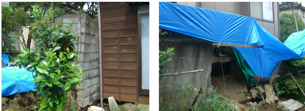
写真-8.21 増し積まれた擁壁の被害例
