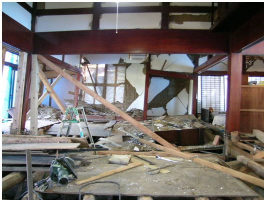
写真-4.3.57 柱の折損、壁の剥落
