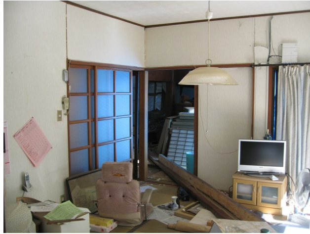
写真-4.3.62 食堂のせっこうボードの亀裂・剥落
