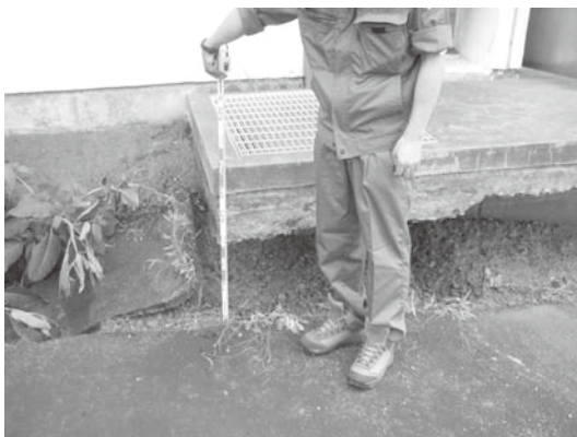
写真-4.8 八坂ポンプ場地盤沈下
