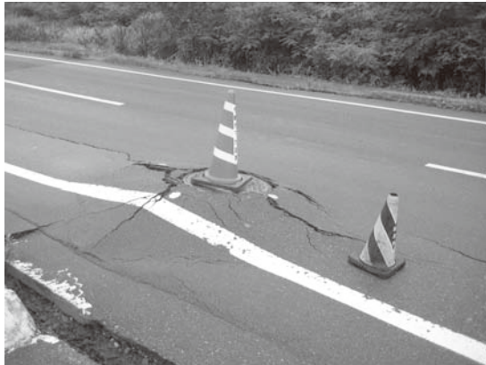
写真-4.1 マンホール隆起 (柏崎市栄町)
