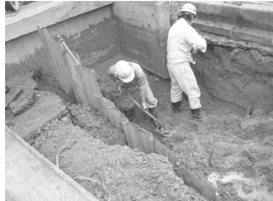
写真-4.7 八坂ポンプ場流出管破断
