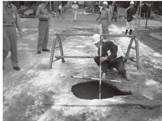
写真-4.9 柳橋ポンプ場圧送管破断
