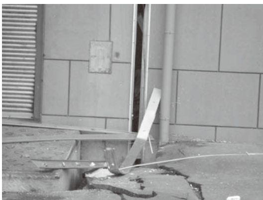
写真-4.11 柏崎市浄化センター 汚泥棟EXP. J損傷
