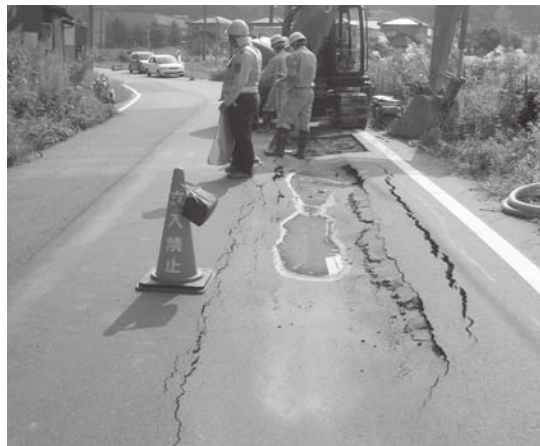
写真-4.16 B都市の管渠被災状況
