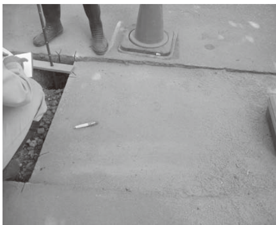
写真-4.15 A都市の管渠被災状況
