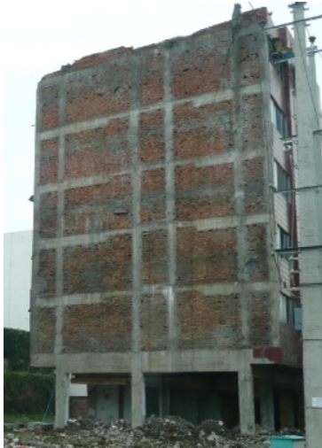
写真 5.7 寸法が大きく異なる 1 階柱と 2 階柱
