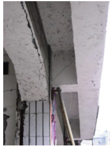
写真 5.8 1 階柱と 2 階柱をつなぐ梁のせん断破壊（都江堰）
