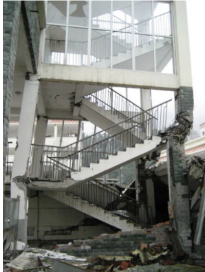
写真 5.13 階段が取り付く柱の破壊（映秀）
