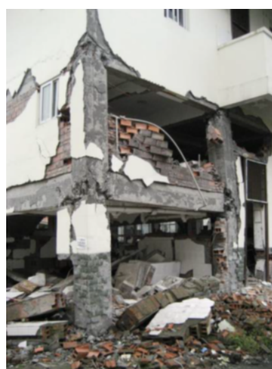
写真 5.12 柱頭・柱脚の曲げ破壊（映秀）
