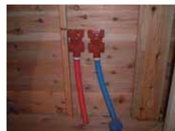
水栓ボックス
