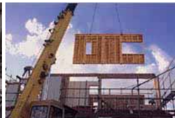
壁面ユニットでの現場組立作業 建方作業と壁面下地+断熱材施工工程が完了。
