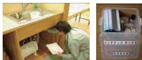
点検風景とメンテナンスボックス
