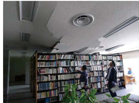
写真 25 内装材(天井材)の被害 (つくば市)
