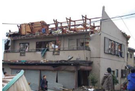
写真6 小屋組の破壊・飛散 (つくば市)
