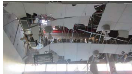
写真18 写真17に示す施設の天井の破壊 (越谷市)
