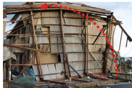
写真21 上部構造の転倒 (つくば市)
