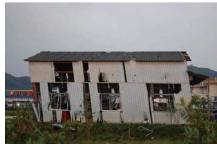
写真20 骨組の残留変形 (つくば市)
