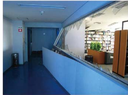
写真 24 内装材の被害 (つくば市)
