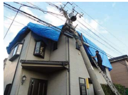
写真 32 電柱の折損による屋根の被害 (越谷市)
