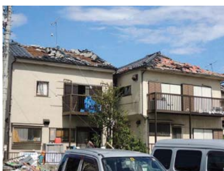
写真3 屋根ふき材の脱落・飛散 (越谷市)
