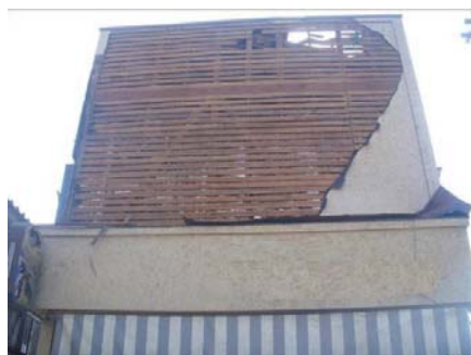
写真4 モルタル外壁の脱落 (つくば市)
