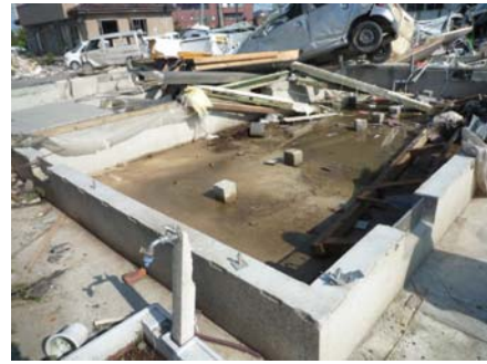
写真12 土台を含む上部構造の飛散（つくば市）
