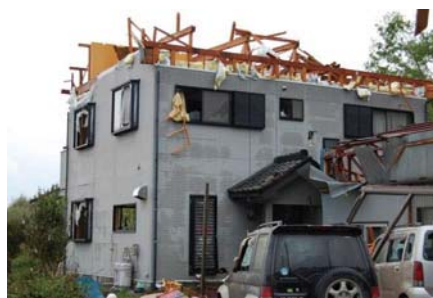
写真5 小屋組の破壊・飛散 (つくば市)
