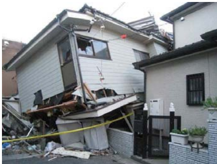
写真11 上部構造の倒壊（越谷市）
