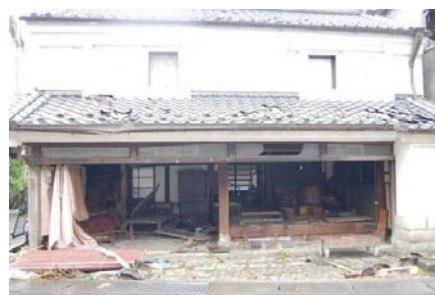
写真 2 開口部の損傷（つくば市）
