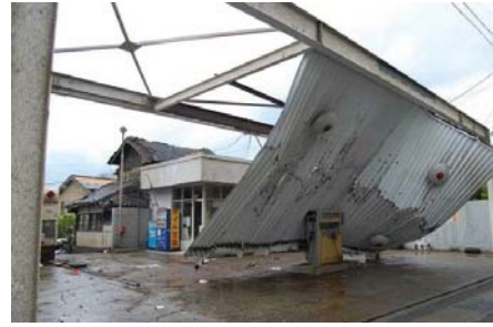
写真 30 ガソリンスタンドの屋根の脱落 (つくば市)
