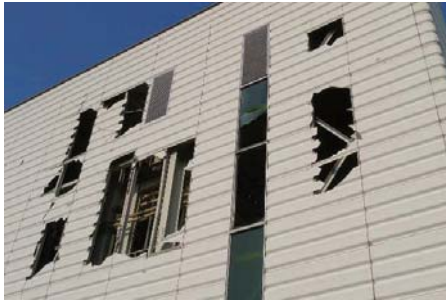
写真16 外壁材とガラスの損傷 (つくば市)
