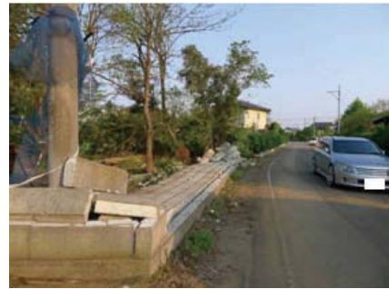
写真 31 石塀の倒壊 (つくば市)
