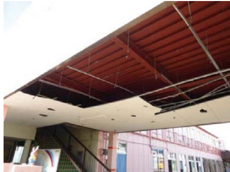
写真19 ピロティの天井の被害 (越谷市)
