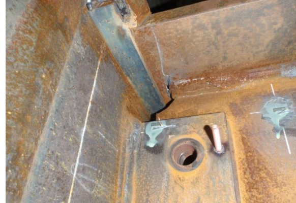
(b) 梁上フランジ貫通き裂, ウェブボルト破断
