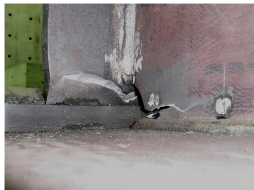
上フランジ破断状況(+7 サイクル)
