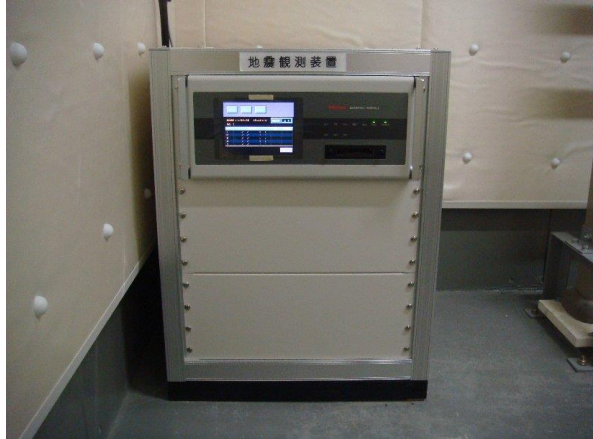
(1-2) 建物 33 階強震観測装置設置用ラック (強震観測装置, モデム, 検出器)
