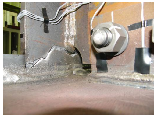
上フランジ破断状況(+16 サイクル)
