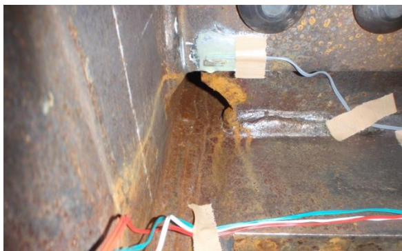
(a) スカラップ底に生じたき裂(2 サイクル)
