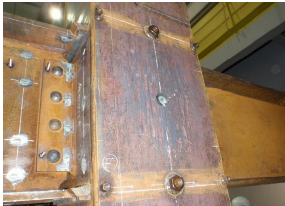
(c) 接合部パネルの塑性化によるミルスケールの剥離
