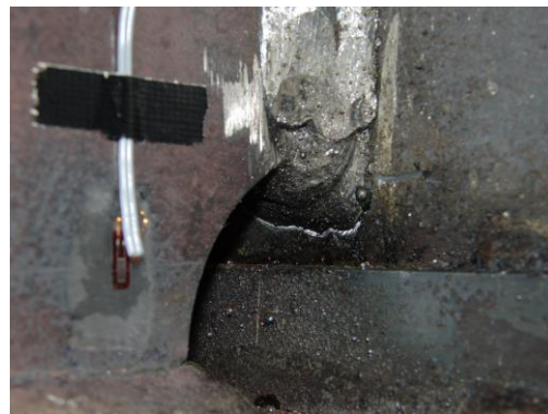
下フランジ側スカラップ底の亀裂(-82 サイクル)
