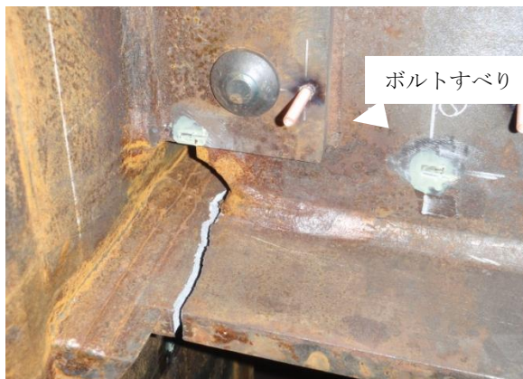
(a) フランジ破断状況(1-サイクル)
