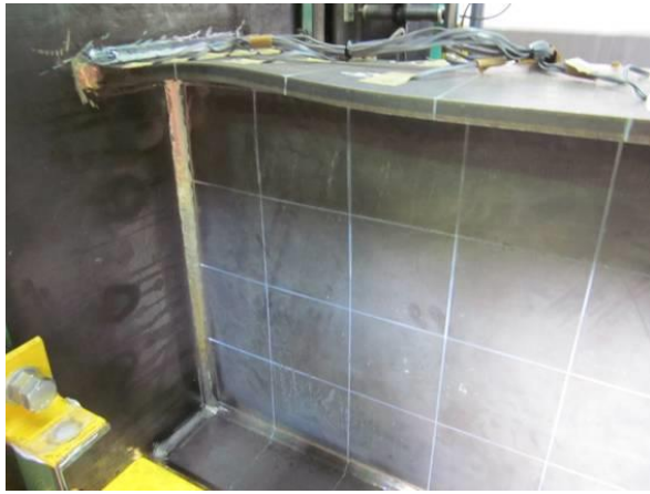
局部座屈進展, 梁端溶接部き裂進展 (-158 サイクル目)
