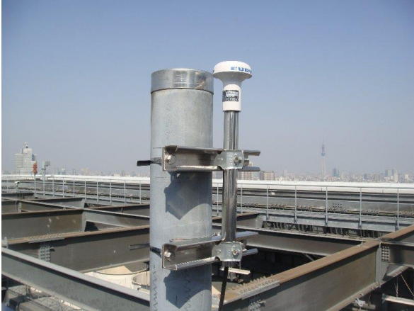
(1-1) 建物屋上設置 GPS アンテナ
