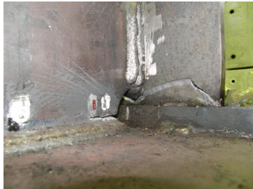
下フランジ破断状況(-20 サイクル)
