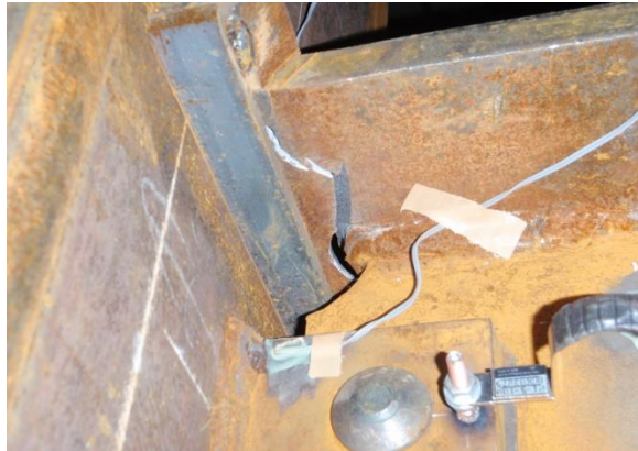
(a) 貫通き裂(フランジ内側から)
