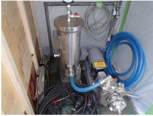
写真7 膜ろ過装置の外観
