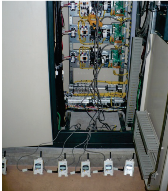
図Ⅲ.2.2.2 クランプ電流ロガーの設置状況（動力盤）
