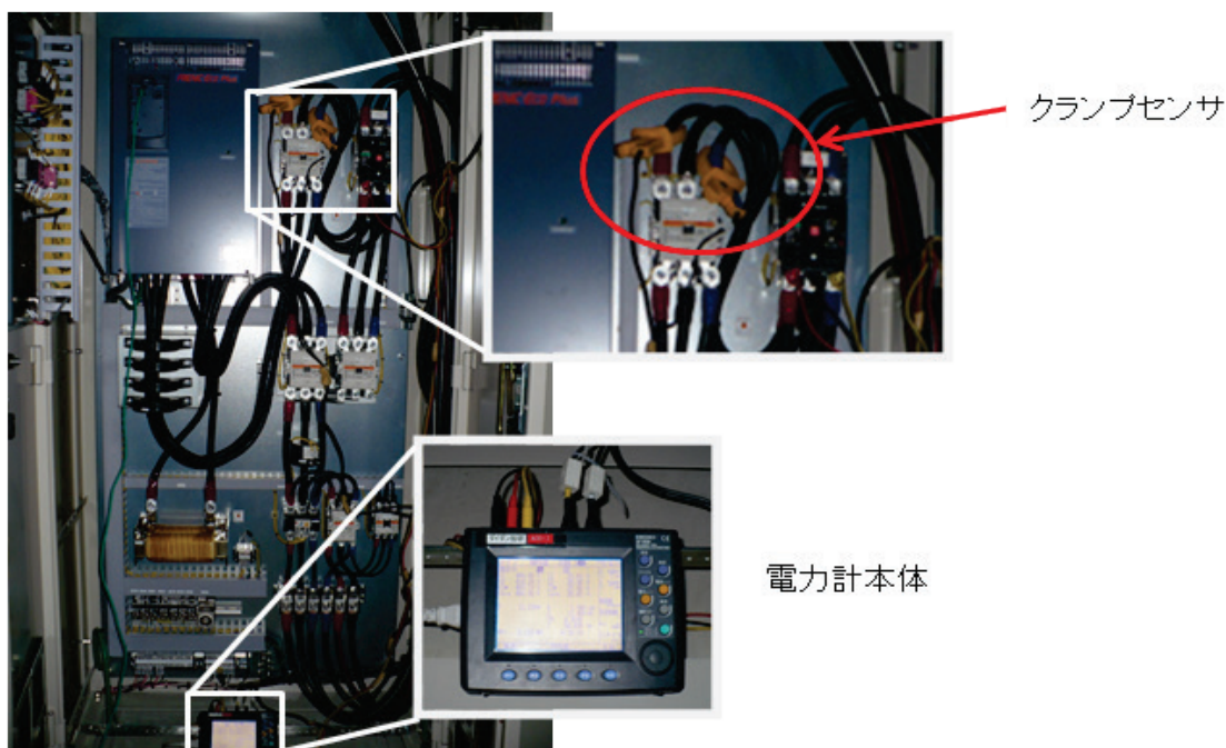
図Ⅲ.2.2.1 電力計の設置状況 (動力盤)
