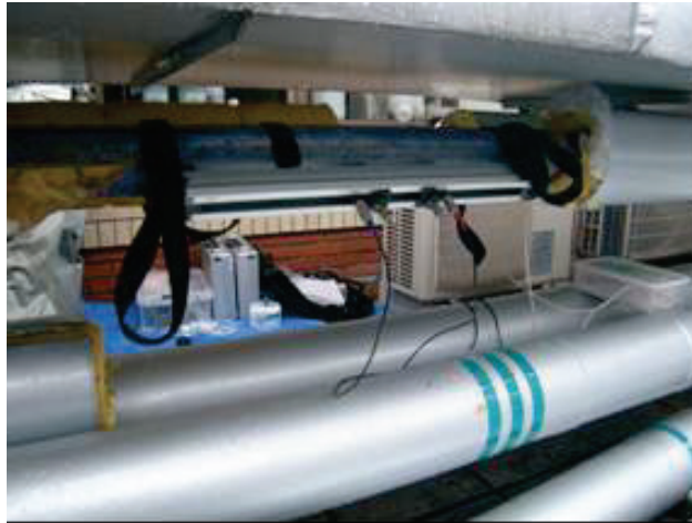
図IV.2.2.3 超音波流量計による冷温水配管流量測定状況（断熱材復旧前）
