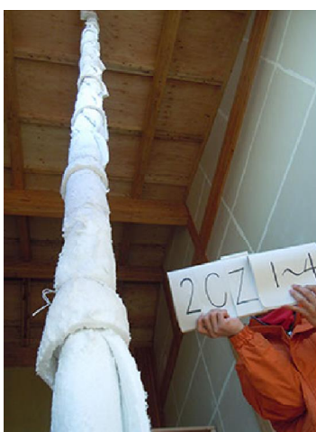
写真 2.5.3-1 熱電対タワー
