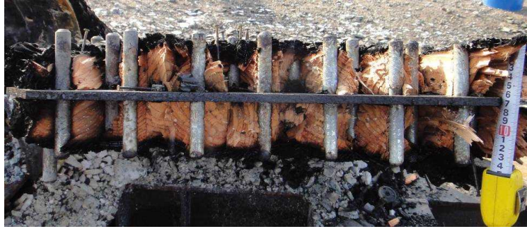
写真 2.7.7-14 柱の曲げ破壊部分断面
