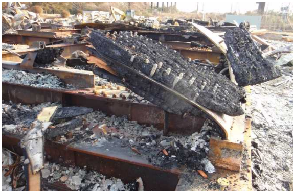
写真 2.7.7-10 残存した柱脚部の様子
