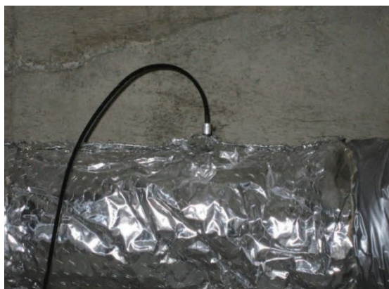
写真 12 換気装置 SA 吹出し側センサー設置状況
