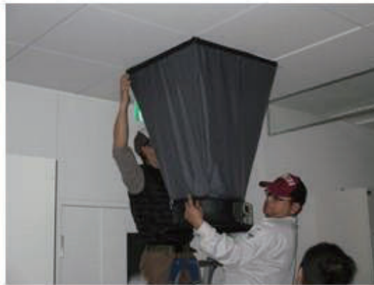
写真 16 SA 風量測定様子
