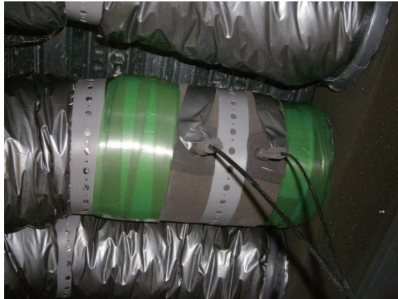
写真 8 室内機吹出しセンサー設置位置
