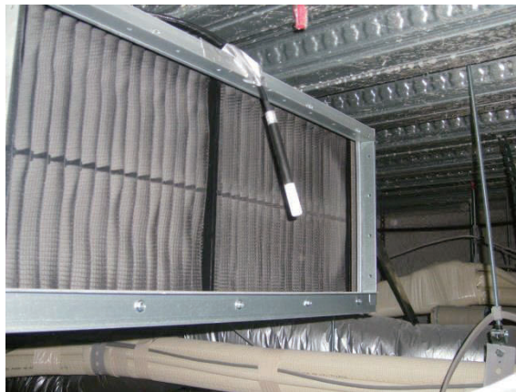
写真 7 室内機吸込み口センサー設置位置
