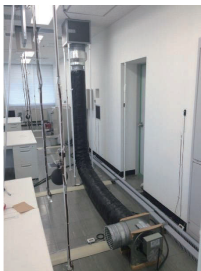
写真 22 SA 側補助ファン、補助ダクト取付位置
