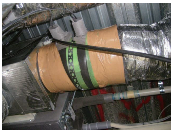
写真 2 室外機ダクト吹出し口センサー設置箇所
