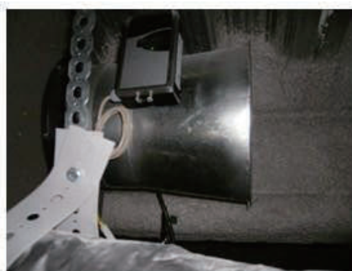
写真 17 既存 RA 吸込み口
