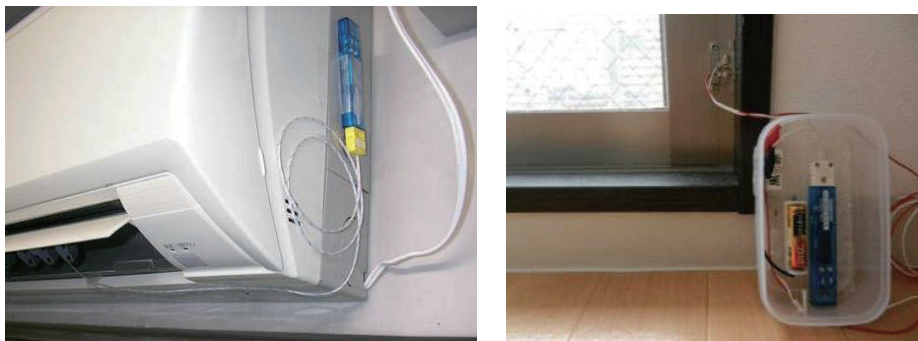
(a) エアコン稼働状況 (b) 窓開閉状況 写真 23 計測器の設置例
