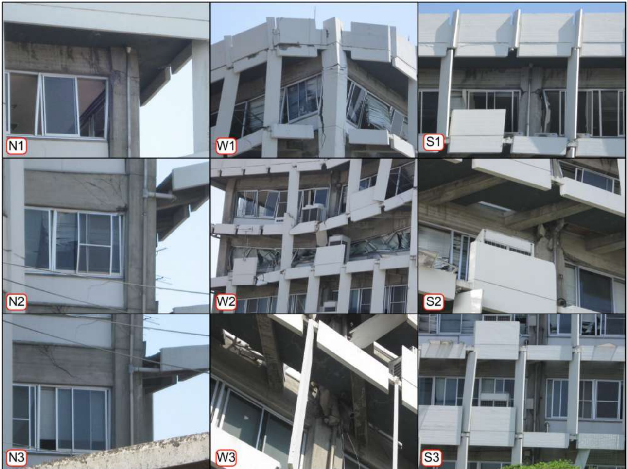
図 9.3.1 北面・西面・何面の損傷状況 [9.3-2]
