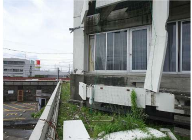
写真 9.3.4 南側2階柱脚部の破壊
