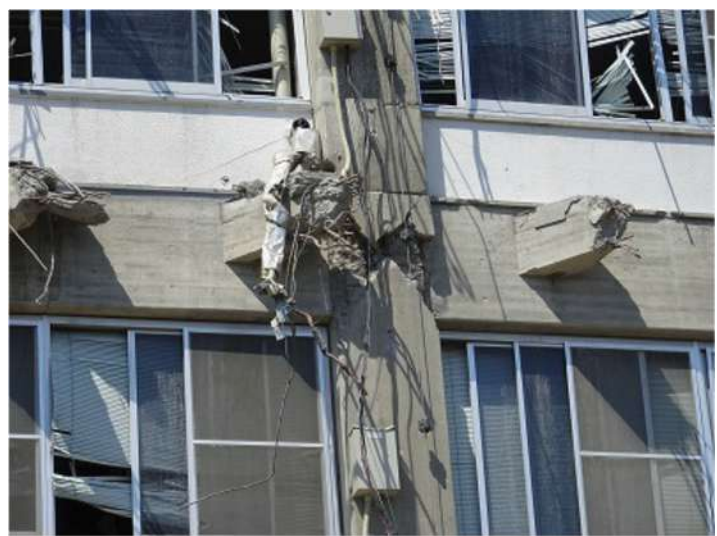
(d) 4階十字形柱梁接合部 (南側面)
