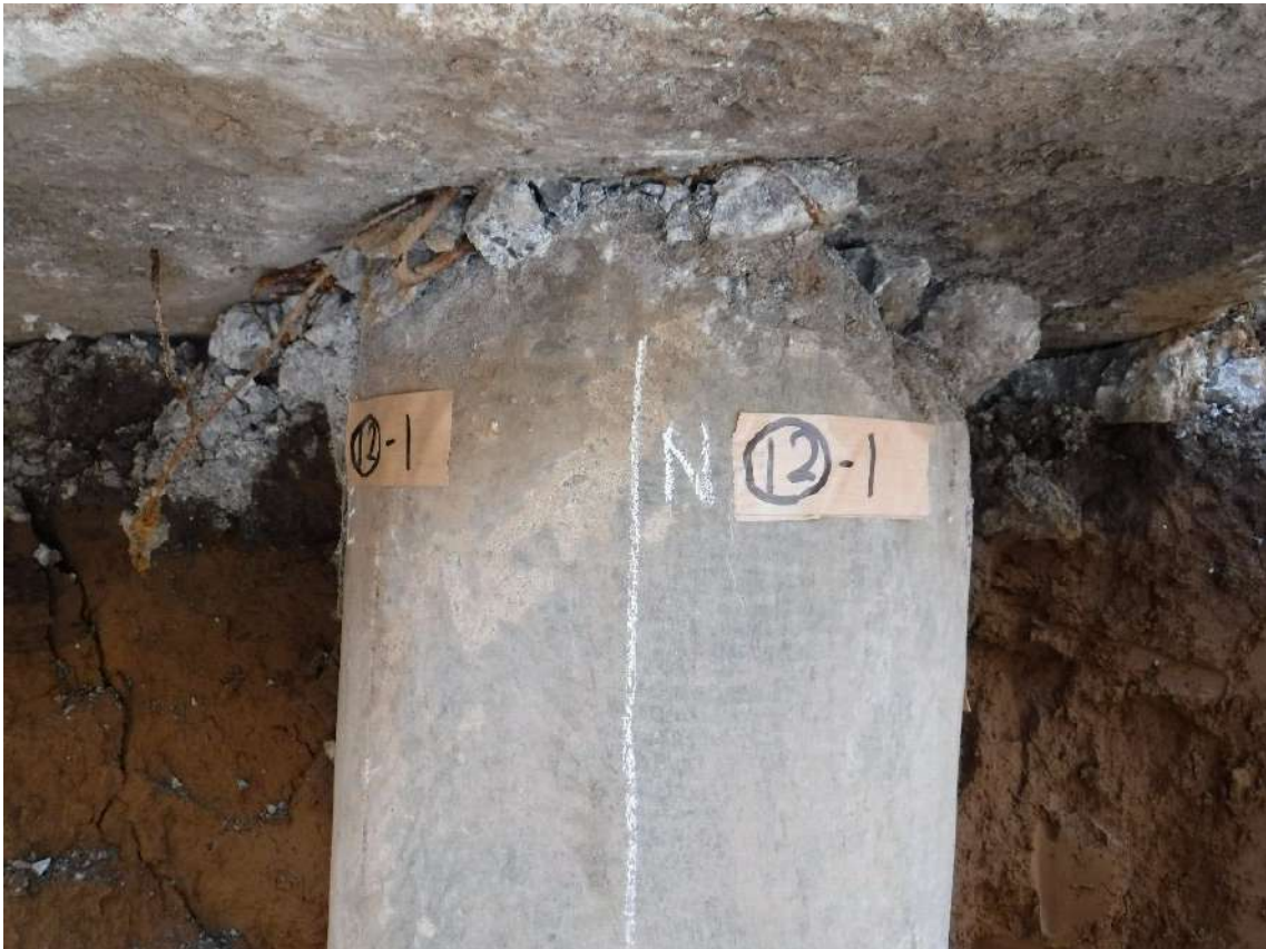
写真 7.4.2.39 杭⑫-1の杭頭部の状況
