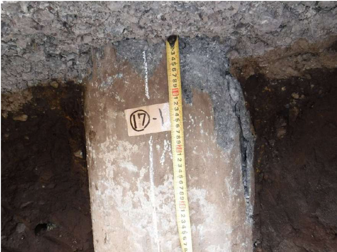
写真 7.4.2.48 杭⑰-1の杭頭部の状況
