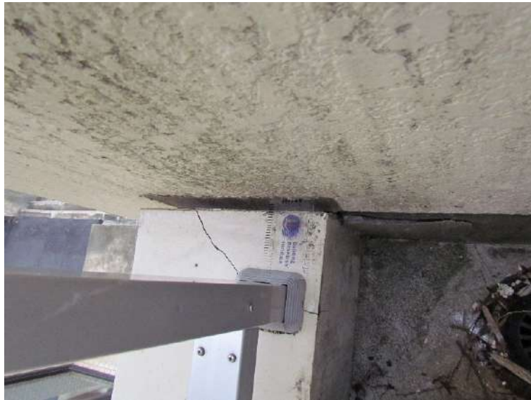
写真 7.4.1.5 境界梁の南側端部目開き量
