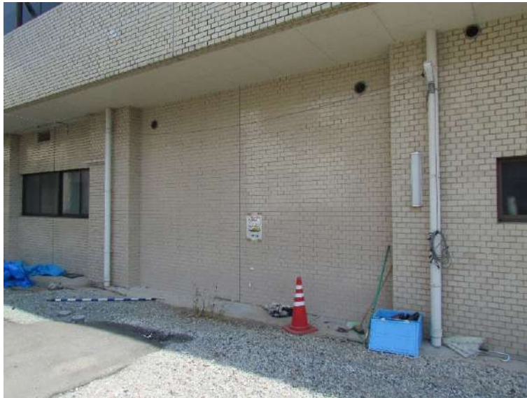
写真 7.4.1.8 損傷度 I の両側柱付壁
