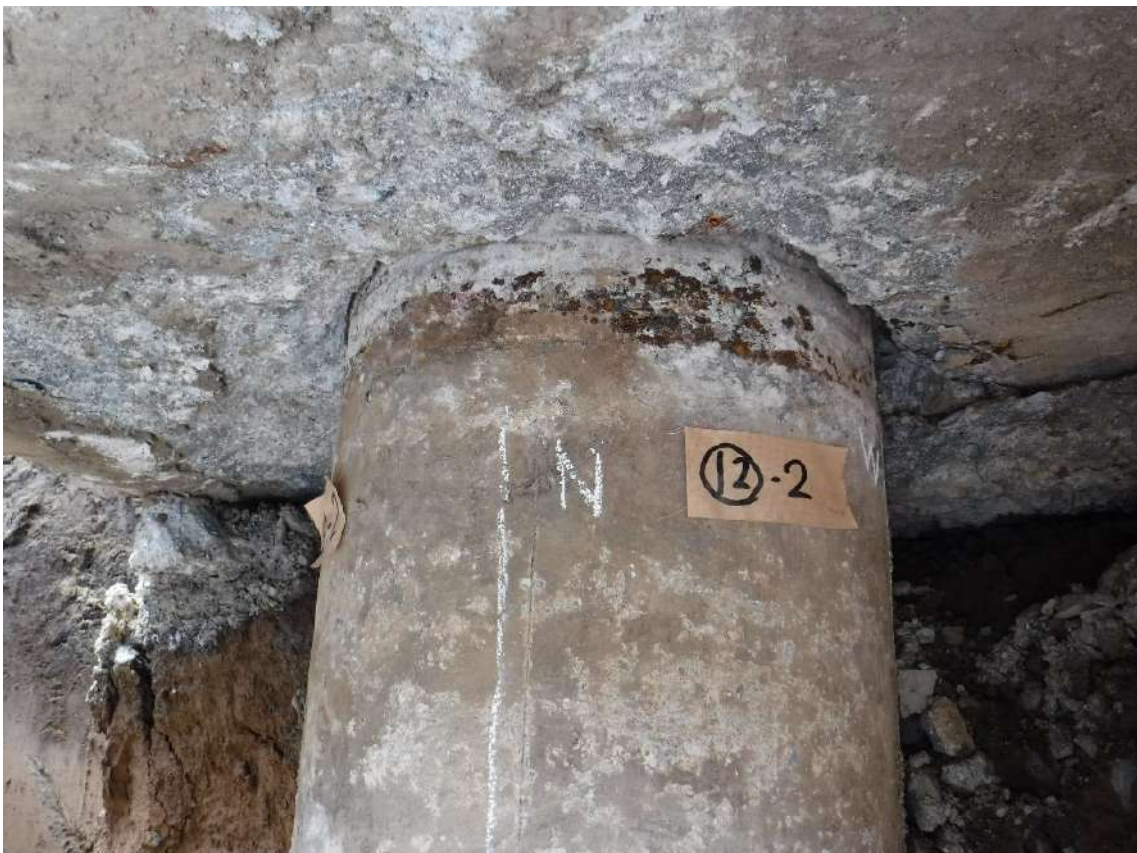
写真 7.4.2.40 杭⑫-2の杭頭部の状況
