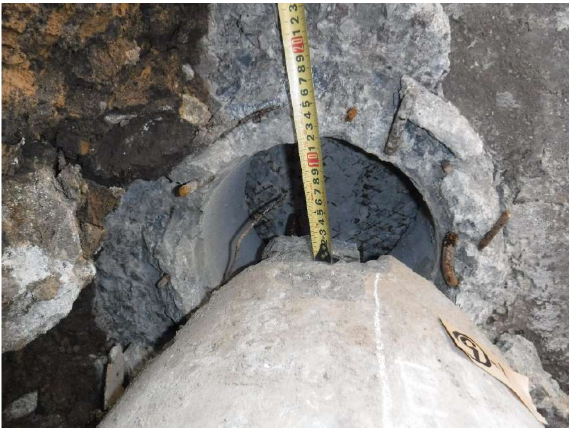
写真 7.4.2.36 杭⑨-1の杭頭部の状況
