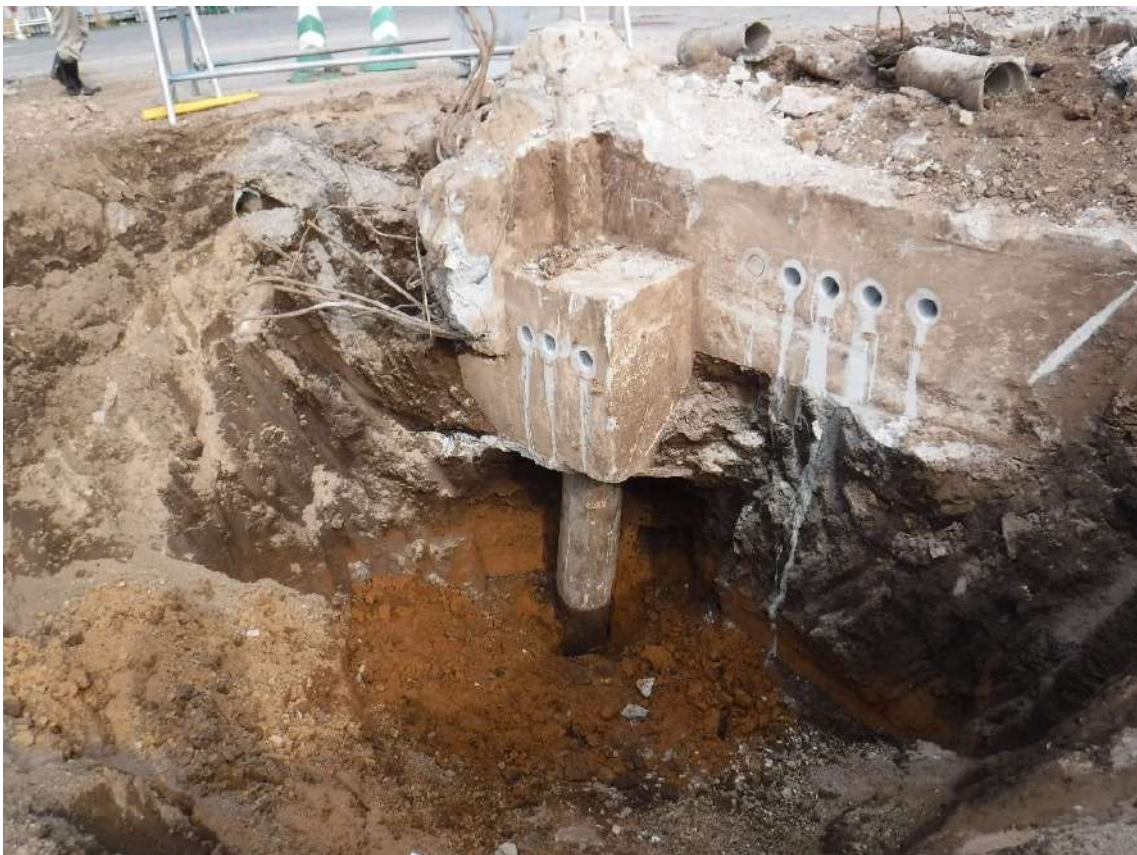
写真 7.4.2.20 基礎フーチング⑯周辺の状況
