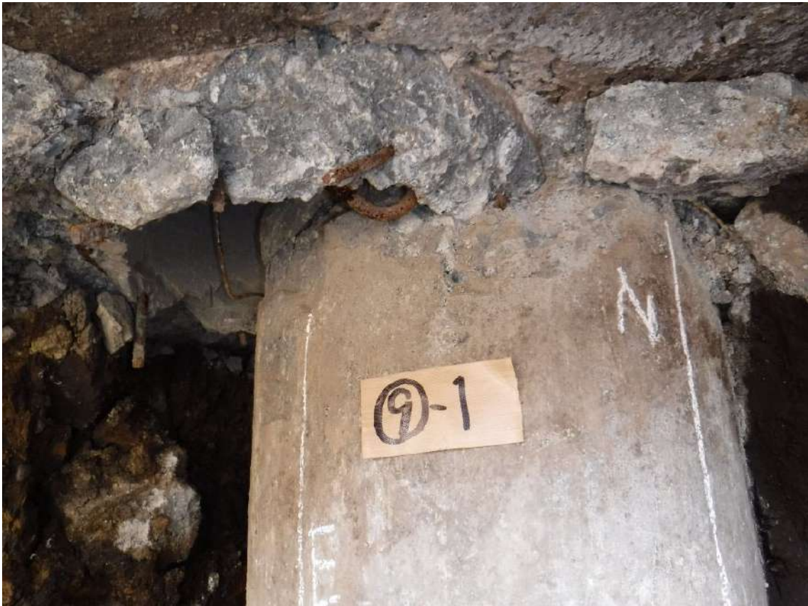
写真 7.4.2.35 杭⑨-1の杭頭部の状況
