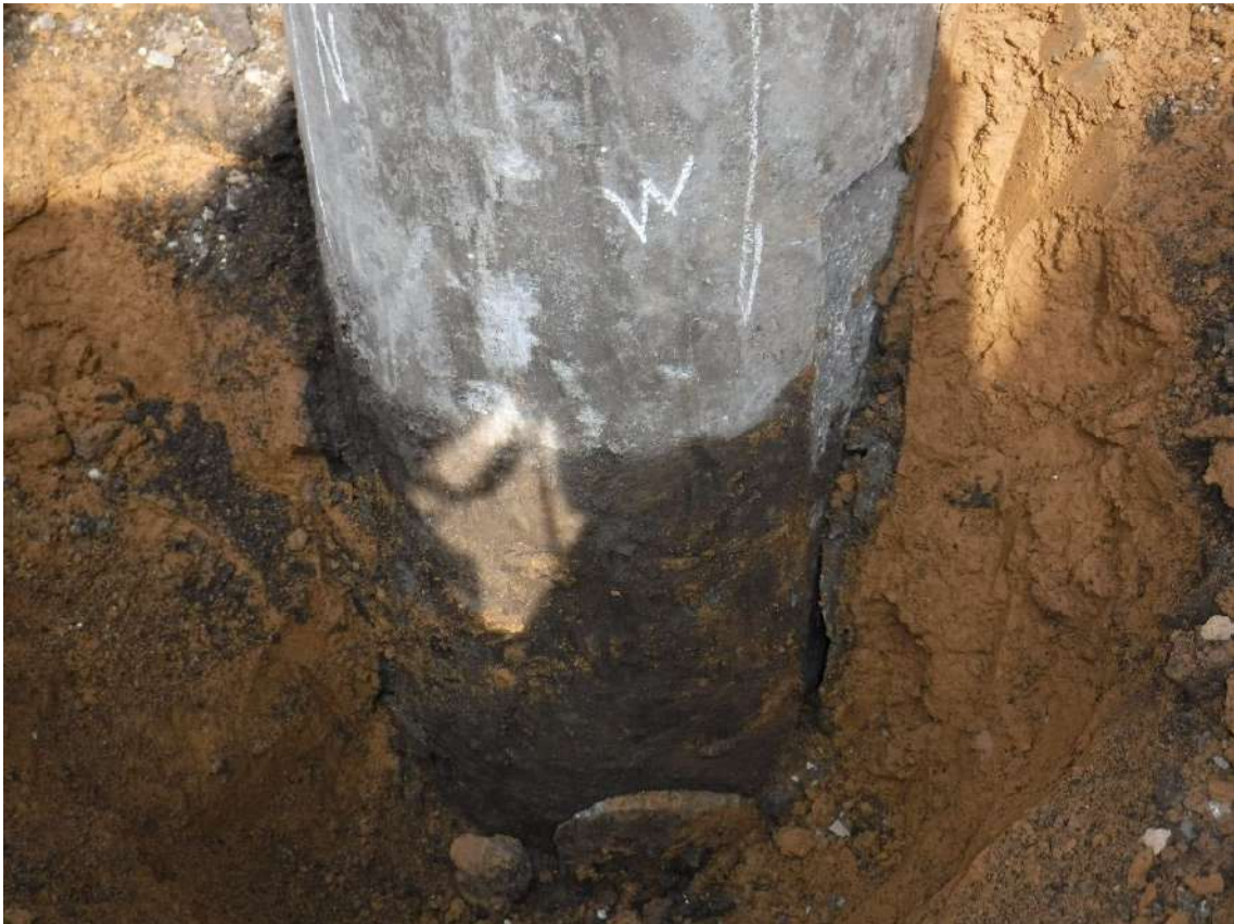
写真 7.4.2.47 杭⑩-1の杭頭部の状況
