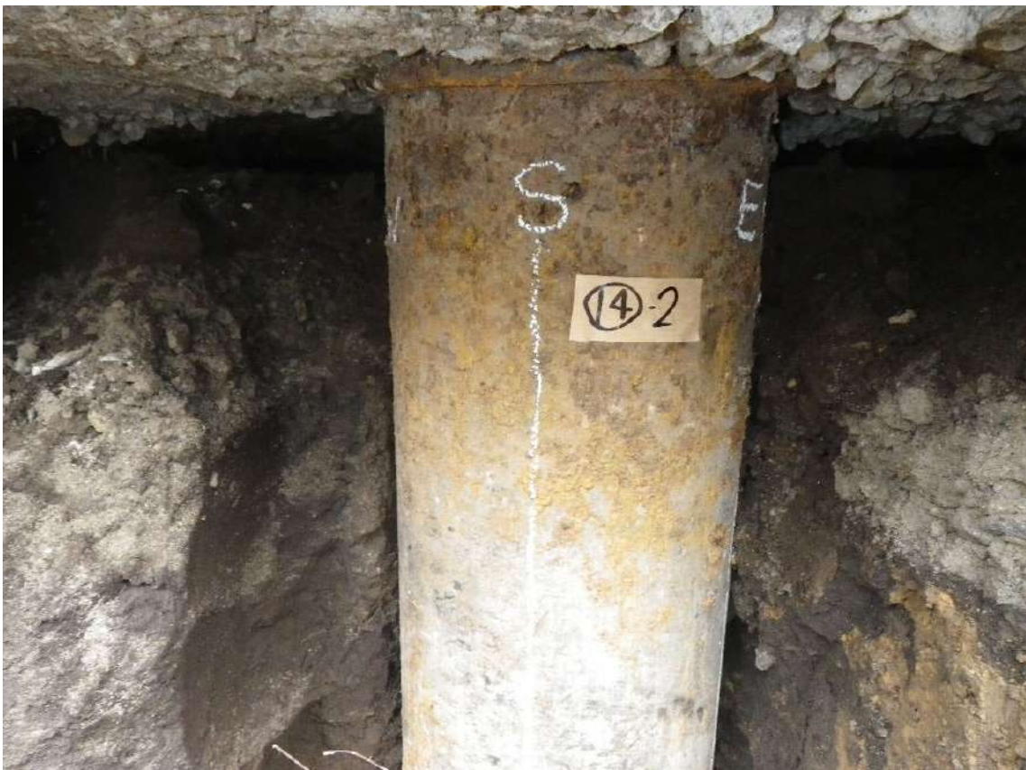
写真 7.4.2.44 杭⑭-2の杭頭部の状況
