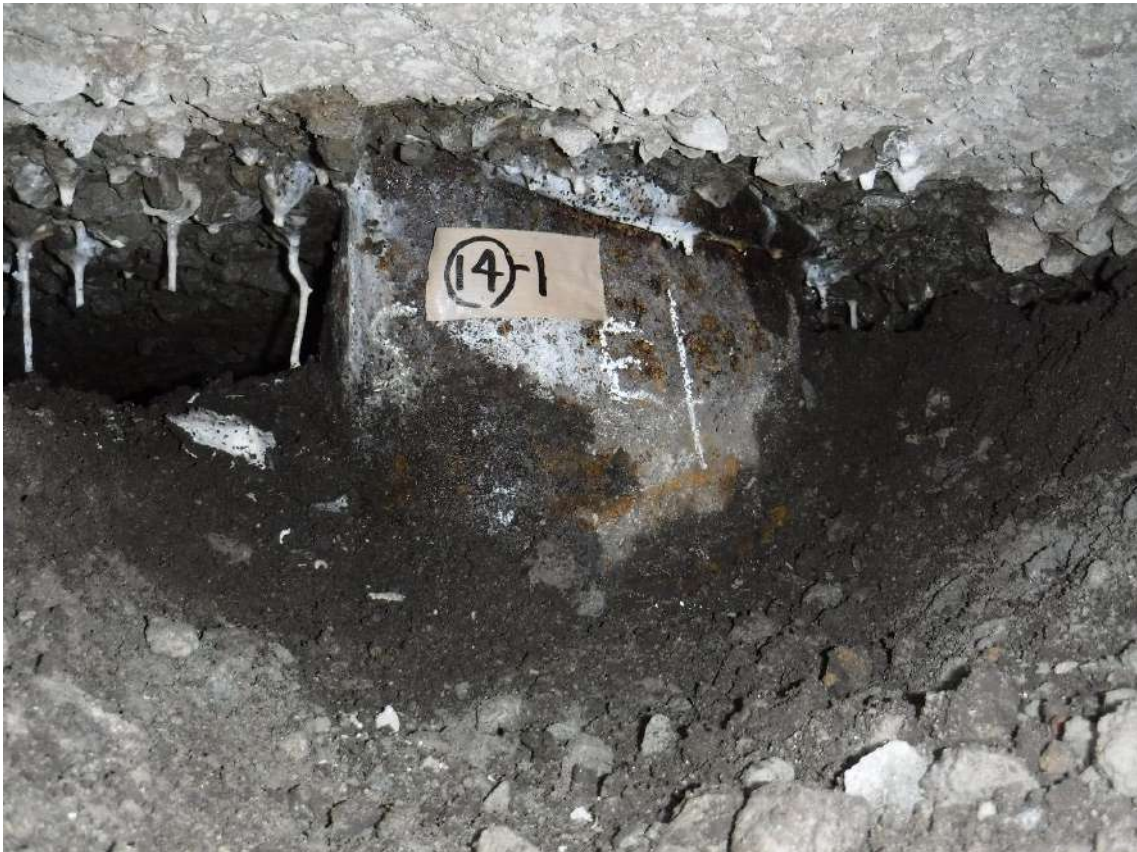
写真 7.4.2.43 杭⑭-1の杭頭部の状況
