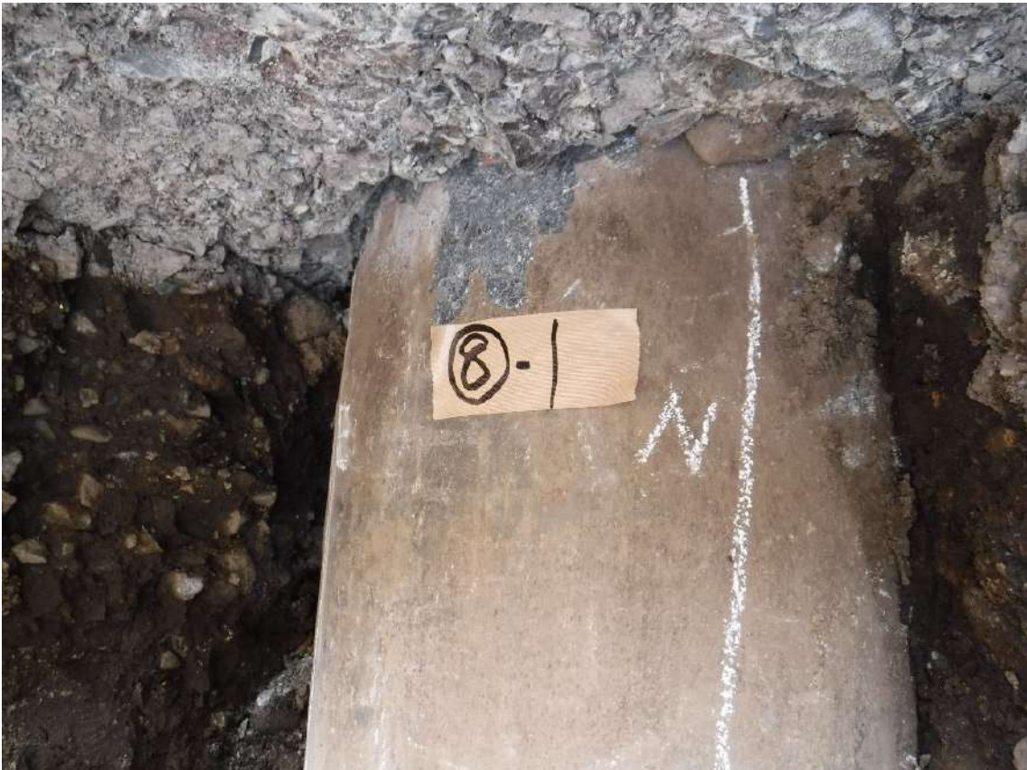
写真 7.4.2.34 杭⑧-1の杭頭部の状況
