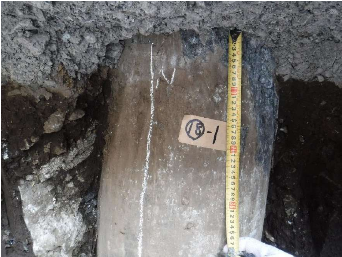
写真 7.4.2.49 杭⑱-1の杭頭部の状況
