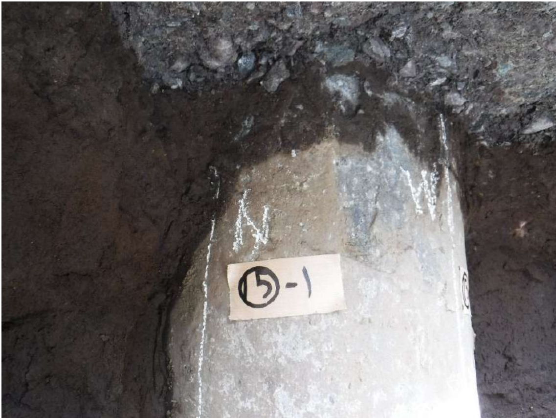
写真 7.4.2.45 杭⑮-1の杭頭部の状況
