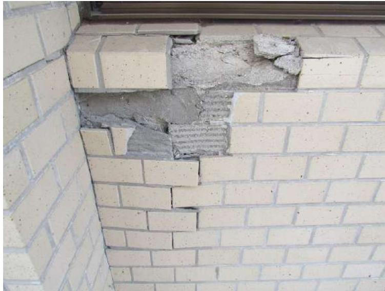
写真 7.4.1.2 タイル剥落部の拡大写真
