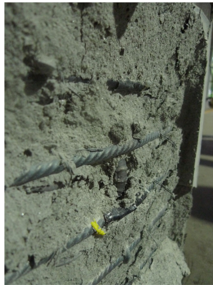
図 A1.3.4-9 主筋の座屈
