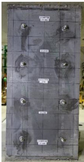
パネル損傷状況
