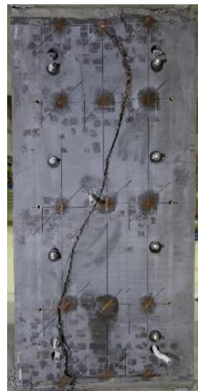
パネル損傷状況
