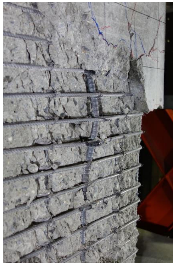
(b) 正面中央主筋の座屈
