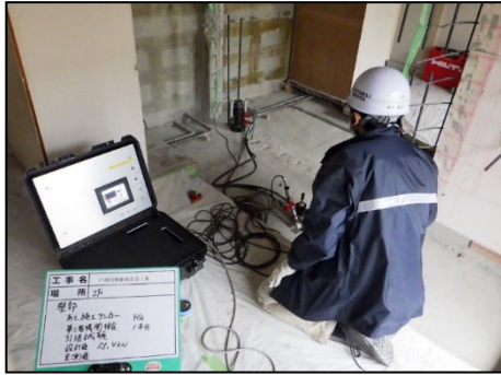
写真 8.3.2-13 あと施工アンカー施工後 試験，引張試験 (第三者機関による確認) (設計荷重 55.4kN)
