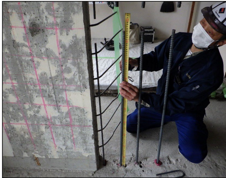
写真 8. 3. 2-29 あと施工アンカー施工後突出部測定状況，下向き No. 1 設計値:950mm，実測値 950mm
