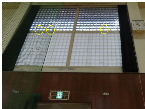
写真 5.6.2(4)-6 ガラスブロックの被害 (建築物 H：金沢市、運動施設)
