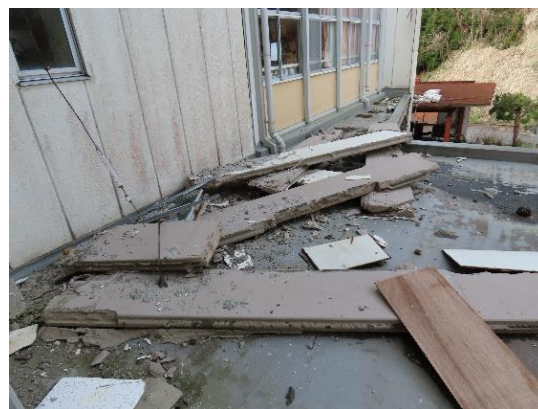
写真 5.6.2.(3)-2 左写真の外壁から落下した ALC パネル (WA-111：輪島市、教育施設)
