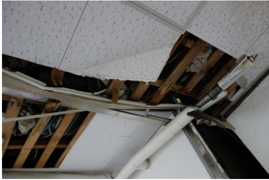
写真 5.6.2. (5)-3 屋内運動場と校舎との間の Exp.J 近傍の内装材の被害 (WA-105 : 輪島市、教育施設)
