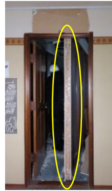
写真 5.6.2. (2)-17 事務所5階 間仕切壁の被害 (壁が床の上を移動) (WA-104 : 輪島市、音楽等用ホールを有する施設)
