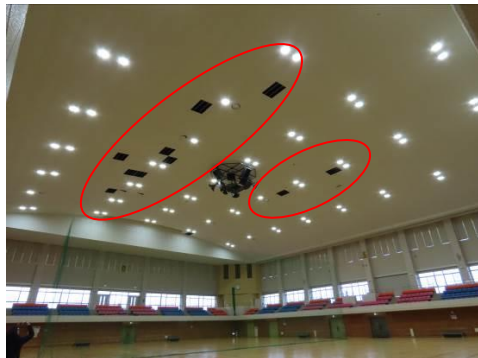
写真 5.6.2.(1)-3 屋内運動場のグラスウール板数枚の落下 （建築物 O：富山市、運動施設）
