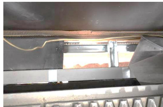
写真 5.6.2.(1)-16 天井材が落下した部分 （建築物 F：金沢市、音楽等用ホール）
