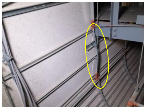
写真 5.6.2.(1)-11 天井下地の変形 (AN-103: 穴水町、音楽等用ホール)
