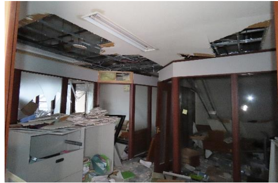
写真 5.6.2.(1)-24 事務所部分 5階執務室天井・間仕切壁の被害（WA-104：輪島市、音楽等用ホールを有する施設）
