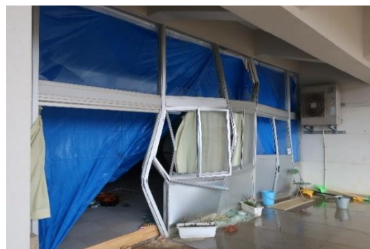
写真 5.6.2(4)-8 校舎 1 階教室のサッシの歪み (WA-106：輪島市、教育施設)
