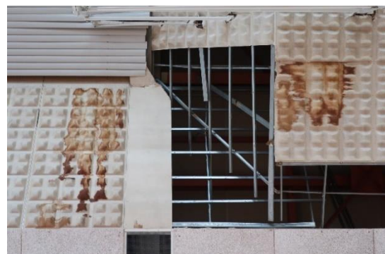
写真 5.6.2.(1)-6 屋内運動場の天井仕上げの脱落（左の写真の丸囲み部分を下から見た様子） （NA-105：七尾市、教育施設）
