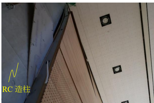
写真 5.6.2.(2)-3 屋内運動場 舞台横の内壁のRC造柱との接合部での外れとはらみ出し（WA-109：輪島市、教育施設）
