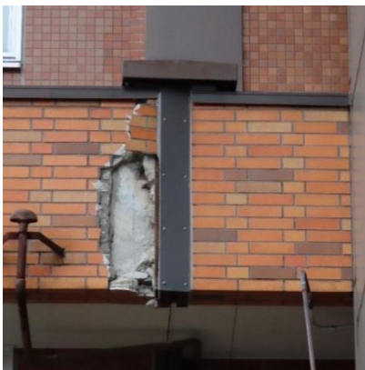
写真 5.6.2.(5)-1 Exp.J 近傍の外装材 の剥離および落下 (建築物 A : 金沢市、行政庁舎)
