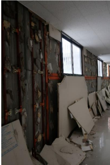
写真 5.6.2.(2)-24 校舎廊下外壁 内側の損傷 (AN-101：穴水町、教育施設)
