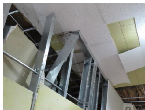
写真 5.6.2.(2)-23 屋内運動場ギャラリー一部分の被害（壁下地材が天井面ボードに支持されていた） (WA-102：輪島市、教育施設)
