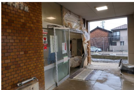
写真 5.6.2(4)-7 校舎玄関サッシの歪み (WA-106：輪島市、教育施設)
