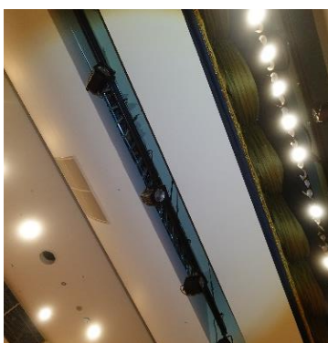
写真 5.6.2.(1)-9 舞台上部の立ち上がり壁の損傷 (AN-103: 穴水町、音楽等用ホール)
