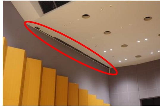
写真 5.6.2.(1)-14 被害状況 （建築物 F：金沢市、音楽等用ホール）
