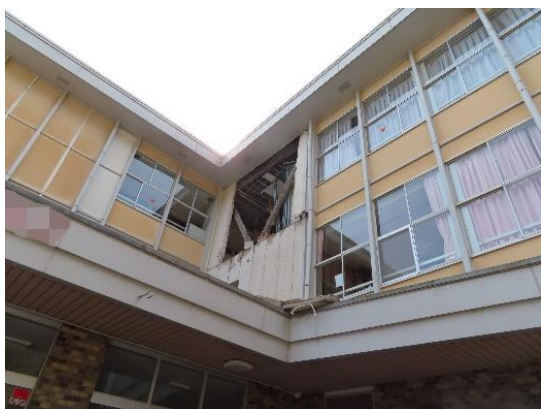
写真 5.6.2.(3)-1 校舎 3 階の ALC パネルによる外壁の脱落 (WA-111：輪島市、教育施設)
