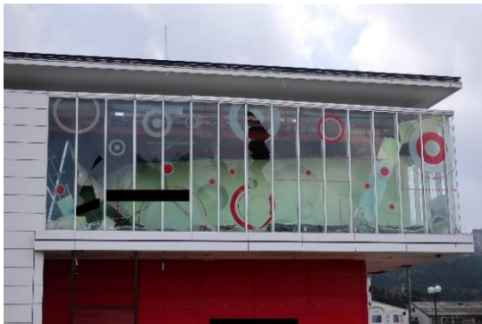
写真 5.6.2(4)-3 サッシの外れやガラスの破損 (WA-15：輪島市、遊技施設)
