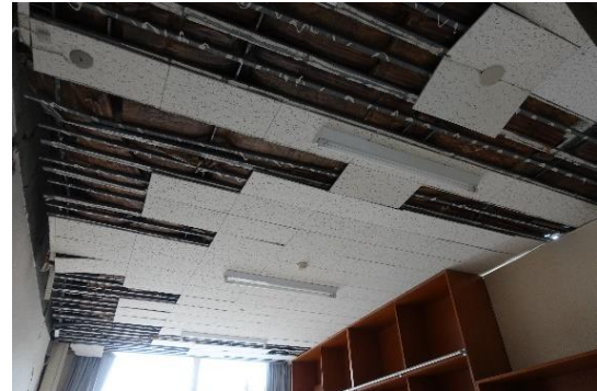
写真 5.6.2.(1)-26 校舎3階教室の天井被害（WA-101：輪島市、教育施設）
