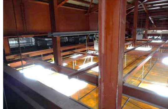
写真 5.6.2.(1)-2 屋内運動場の天井材垂れ下がり部分の支持状況 （建築物 C：金沢市、運動施設）
