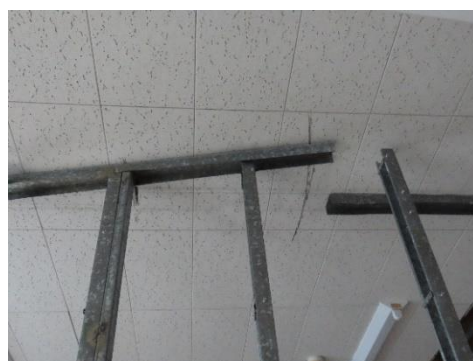
写真 5.6.2.(2)-21 校舎3階 教室の間仕切壁の被害（左写真の壁上端拡大） (WA-101：輪島市、教育施設)
