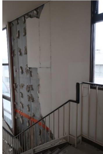
写真 5.6.2.(2)-25 校舎階段室外 壁内側の損傷 (AN-101：穴水町、教育施設)
