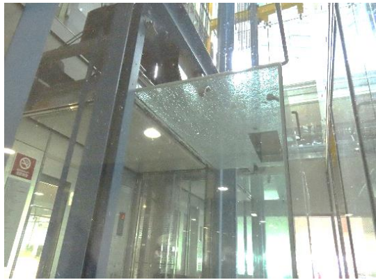
写真 5.6.2. (5)-5 エレベーターかごの天井ガラスの被害 (建築物 N : 富山市、行政庁舎)
