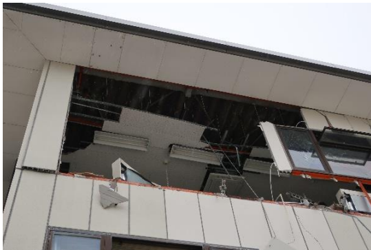
写真 5.6.2.(3)-9 校舎の ECP による外壁の脱落 (AN-101 : 穴水町、教育施設)
