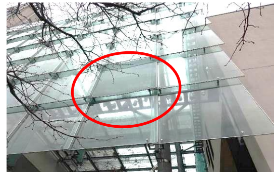
写真 5.6.2(4)-4 DPG 構法のガラスの破損 (建築物 P：富山市、商業施設（屋外空間）)
