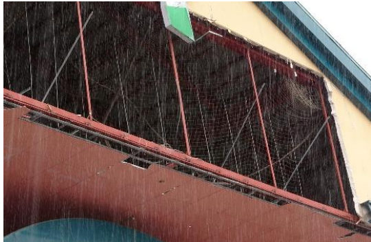
写真 5.6.2.(3)-7 ALC パネルによる外壁の脱落 (WA-14：輪島市、商業施設)
