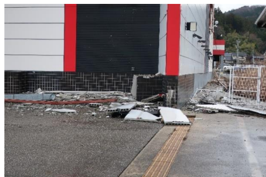
写真 5.6.2.(3)-14 脱落した ECP (WA-15 : 輪島市、遊技施設)
