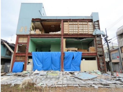
写真 5.6.2.(3)-17 ALCパネル、コンクリートブロック壁の脱落・転倒 (NA-04: 七尾市、事務所)
