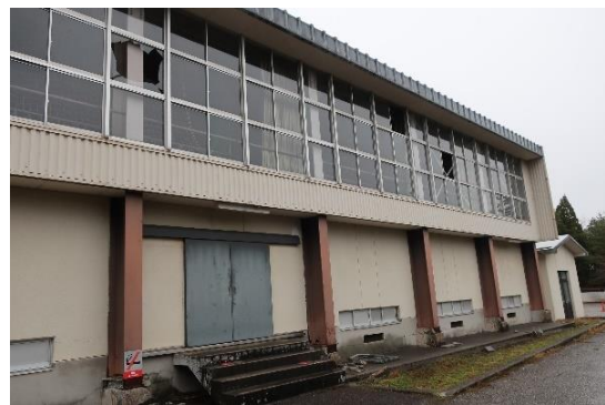
写真 5.6.2(4)-2 屋内運動場のガラスの破損・脱落、障子の脱落 (AN-101：穴水町、教育・訓練施設)
