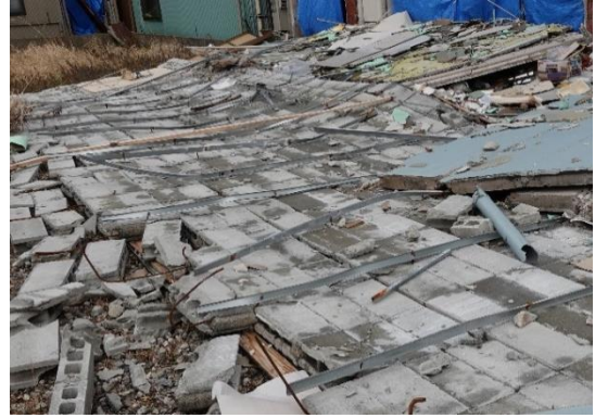
写真 5.6.2.(3)-18 コンクリートブロック壁の脱落・転倒 (NA-04: 七尾市、事務所)
