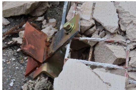
写真 5.6.2.(3)-4 鉄骨屋外階段付近の落下した ALC パネル (WA-111：輪島市、教育施設)
