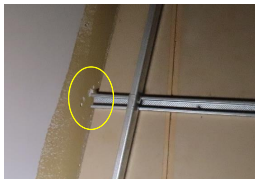
写真 5.6.2.(1)-8 野縁周辺の壁の損傷 (WA-104: 輪島市、音楽等用ホール)
