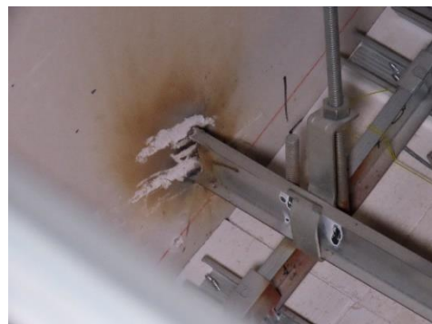
写真 5.6.2.(1)-12 天井下地の衝突によると思われるボード材の損傷 (AN-103: 穴水町、音楽等用ホール)
