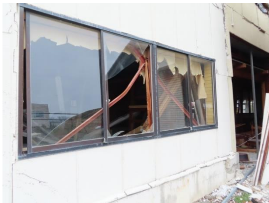
写真 5.6.2(4)-11 山形鋼ブレースの座屈 (SU-04: 珠洲市、事務所)
