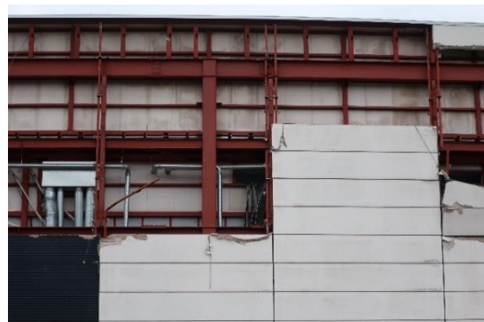
写真 5.6.2.(3)-12 ECP による外壁の被害 (WA-15 : 輪島市、遊技施設)
