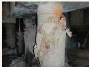
写真3 既製杭の大破 (共同住宅)
