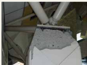
写真2 定着部の被害 (体育館)
