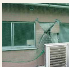
写真1 非耐力壁の大破 (庁舎)
