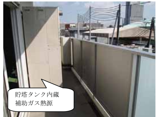
写真 5 ソーラー給湯システム実用化製品設置例 (ベランダ内)
