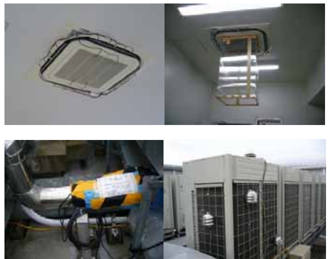
図 6 個別分散型空調機の性能測定
