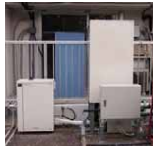
写真1 ガスエンジン発電ユニット
