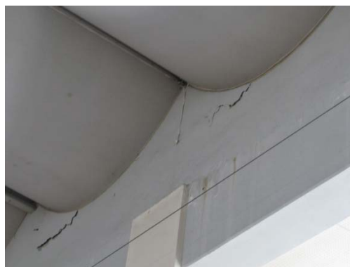
写真 4.3-2 屋根支承部のモルタルの剥離
