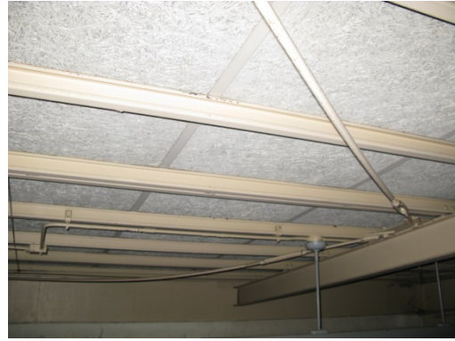
写真 4.3-6 屋根ブレースのたわみ
