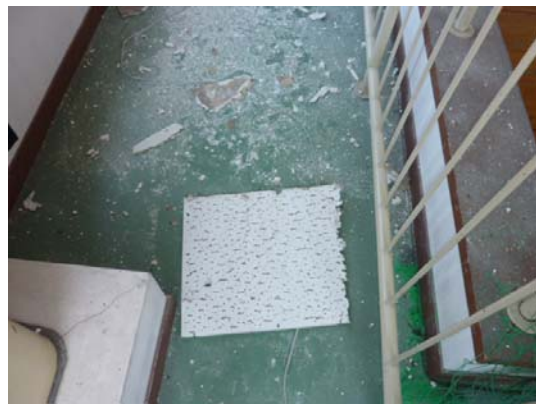
写真 4.2-8 脱落した天井（せっこうボード）
