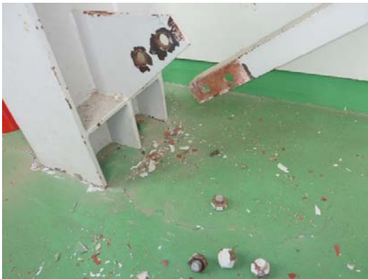
写真 4.1-11 ボルトの破断（端部）
