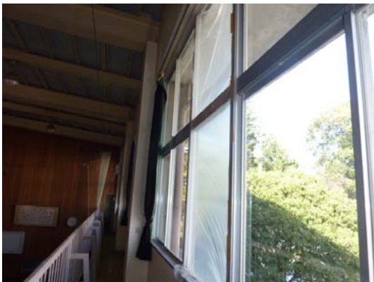
写真 4.2-27 窓ガラスの破損
