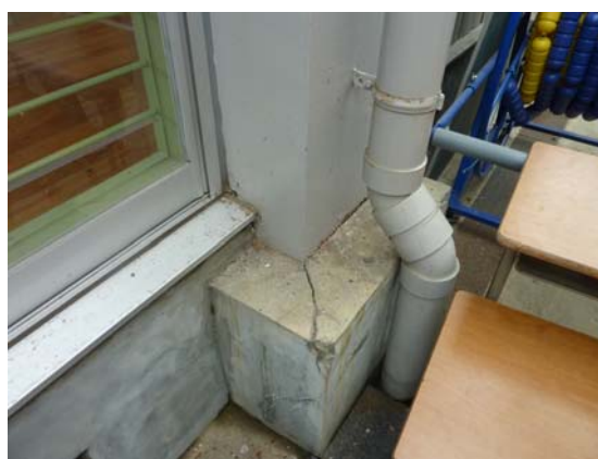
写真 4.1-2 根巻柱脚のコンクリートのひび割れ
