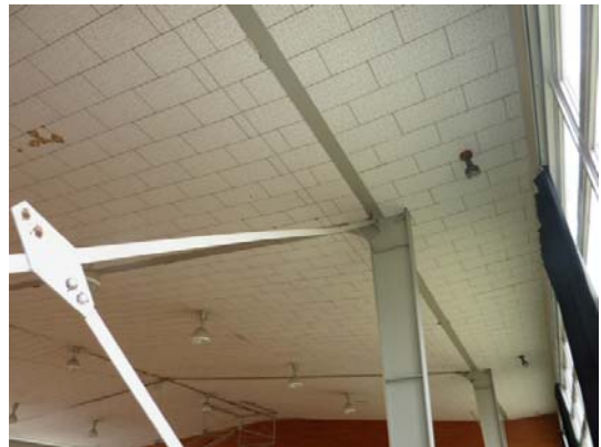
写真 4.1-12 ブレースの座屈
