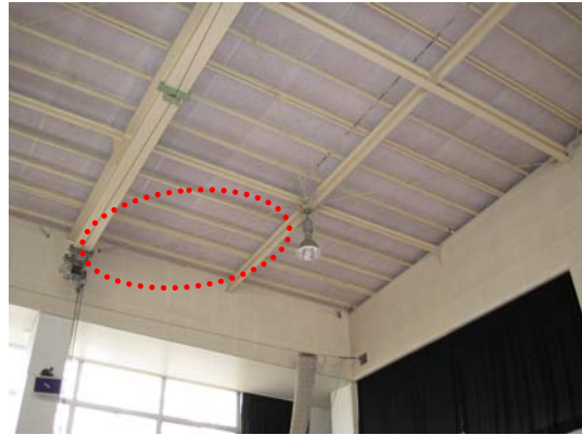
写真 4.1-30 屋根面水平ブレースのたわみ
