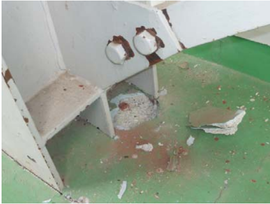
写真 4.1-13 接合部でのボルトの滑り、 柱脚部でのコンクリートの剥離
