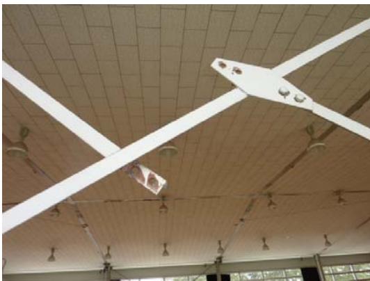
写真 4.1-9 ボルトの破断（交差部）
