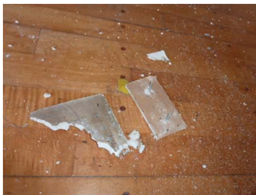
写真 4.2-13 脱落したせっこうボード片と合板片
