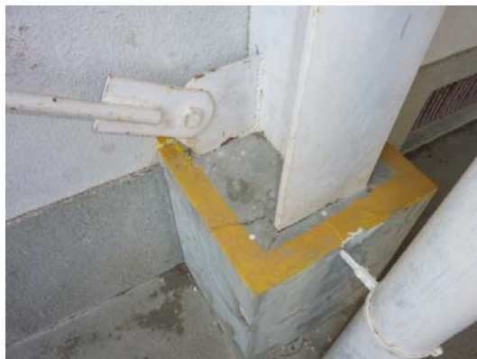
写真 4.2-15 柱脚部のコンクリートの亀裂
