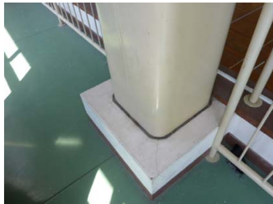
写真 4.2-4 柱脚部でのコンクリートの亀裂
