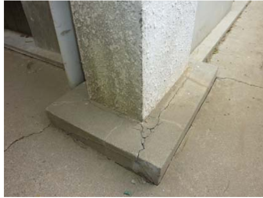
写真 4.1-18 柱脚のコンクリートのひび割れ
