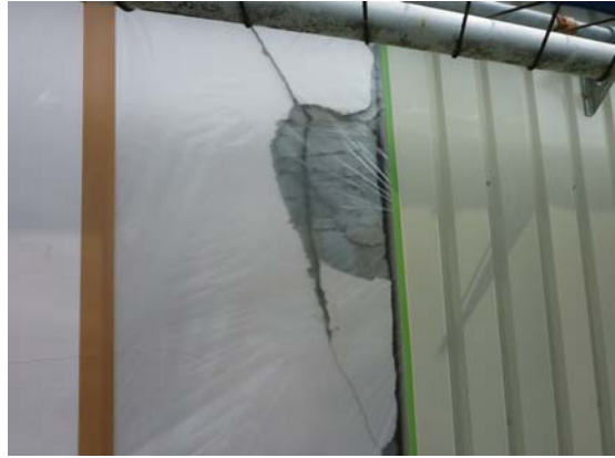
写真 4.1-4 コンクリートのひび割れ及び 剥落 (外壁)
