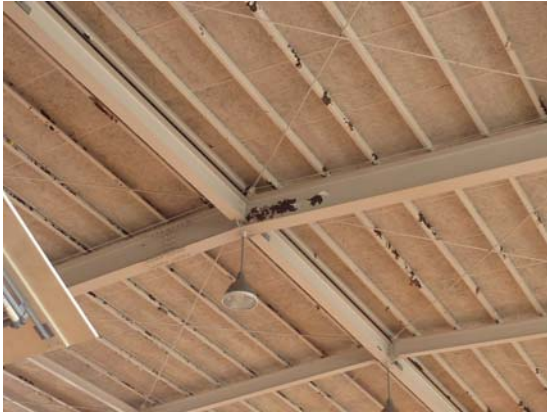
写真 4.1-3 降伏によると見られる 塗装の剥がれ
