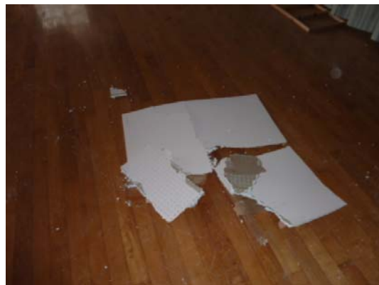
写真 4.1-16 脱落したせっこうボード
