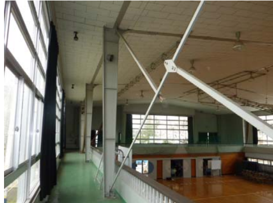
写真 4.1-8 ブレース構面の被害
