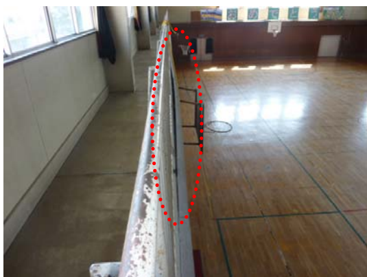
写真 4.2-18 アリーナの内壁の傾斜
