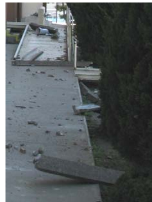
写真 4.3-9 軒先から落下したモルタル仕上げ
