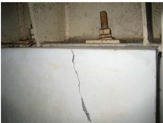
写真 4.1-31 屋根支承部でのコンクリートの亀裂
