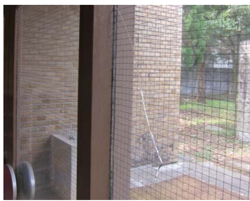
写真 4.1-6 窓ガラスの割れ
