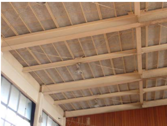
写真 4.2-25 屋根面水平ブレースのたわみ
