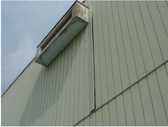
写真 4.1-5 金属サイディングの外れ (外壁)
