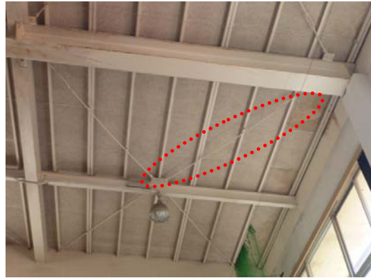
写真 4.2-2 屋根面水平ブレースのたわみ
