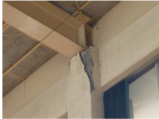
写真 4.2-24 屋根支承部でのコンクリートの剥落
