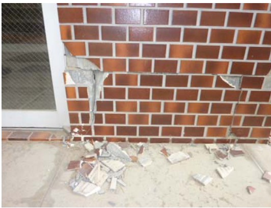
写真 4.1-19 外壁タイルの剥落
