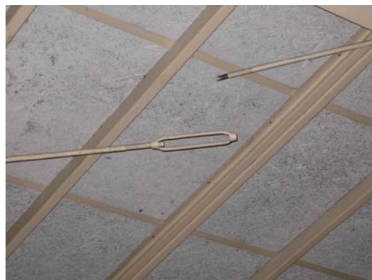
写真 4.2-26 屋根面水平ブレースの破断
