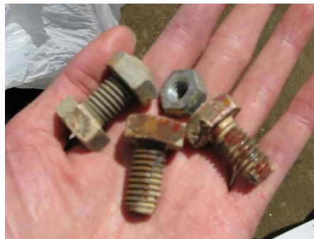
写真 4.3-10 落下したボルト
