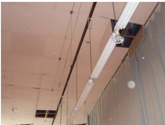
写真 4.1-15 天井の脱落（天井下地は木製）
