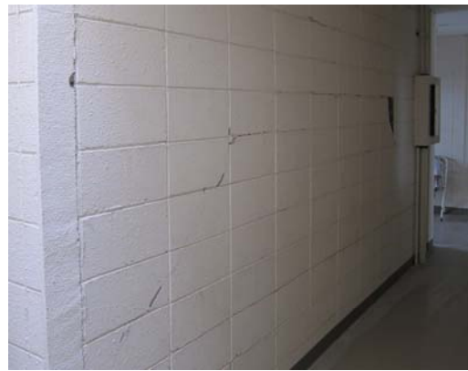
写真 4.1-20 コンクリートブロック壁のひび割れ
