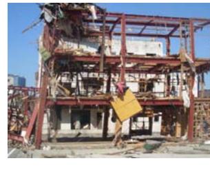
大きな残留変形
