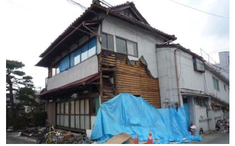
部分的な崩壊
