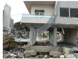
洗掘による基礎の露出
