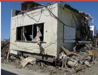
2階建て建築物の1階部分の層崩壊
