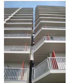
地盤の相対沈下
