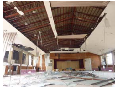
天井材の脱落
