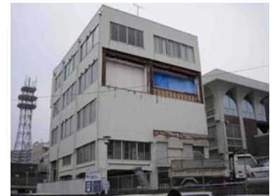
外装材の脱落
