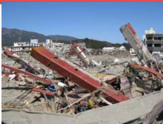
流失（柱頭接合部の破壊）
