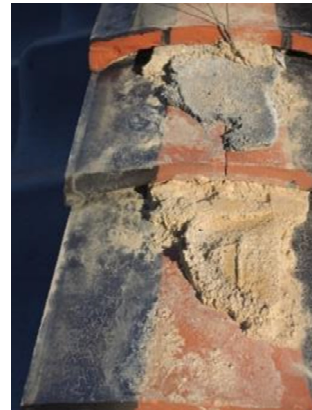
写真 2. 3. 2 棟部ののし瓦の脱落部分
