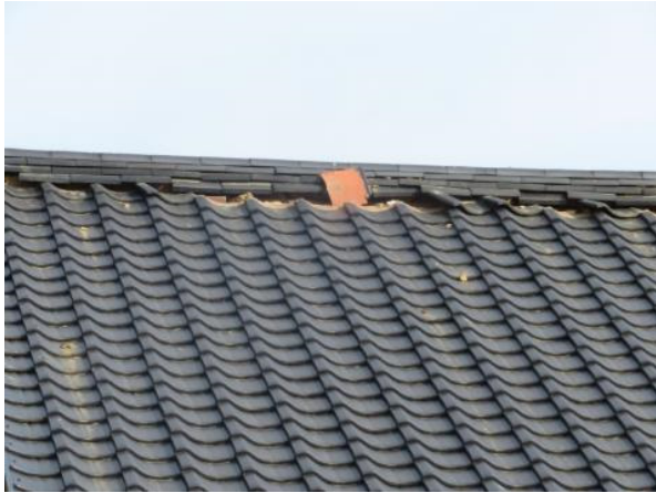
写真 2.8.3 東側棟の半端瓦の脱落
