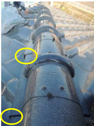
写真 2. 3. 3 隅棟部の状況
