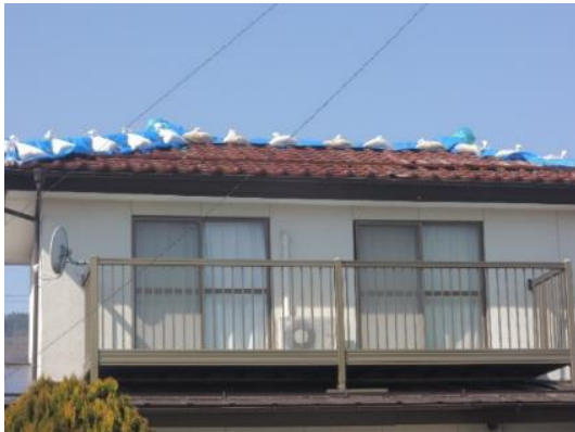
写真 2.9.1 住宅②の周辺で確認した棟部の被害
