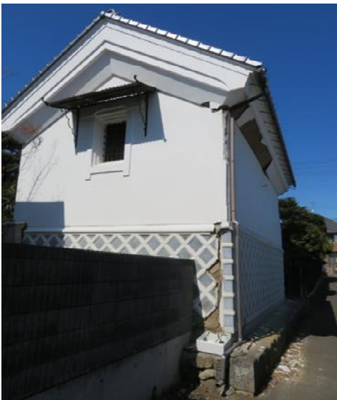
写真 3.1.5 外壁の漆喰壁に割れが生じた土蔵
