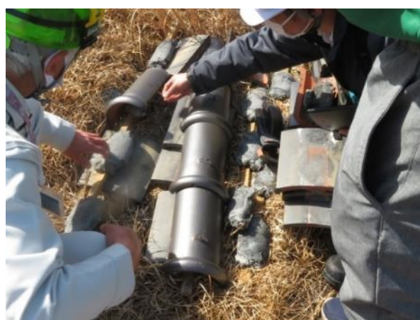
写真 2.9.5 脱落した棟部
