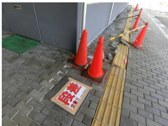
写真 3.3.2 公共施設での敷地地盤の変状
