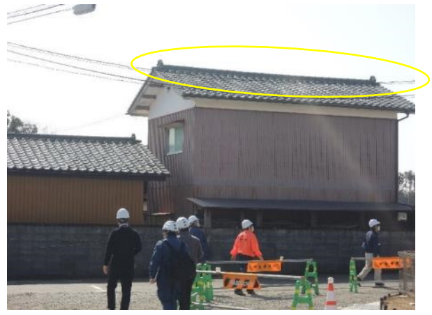
写真 2.9.10 過去の震災後に棟部の改修がされた可能性がある屋根
