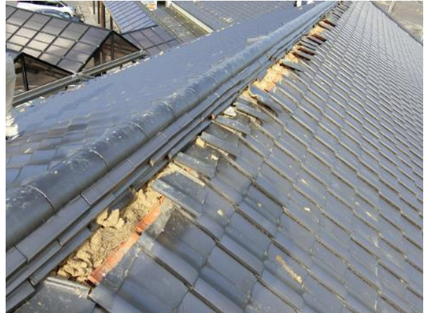
写真 2.8.4 東側棟の半端瓦の脱落
