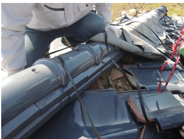
写真 2.1.3 隅棟部の状況
