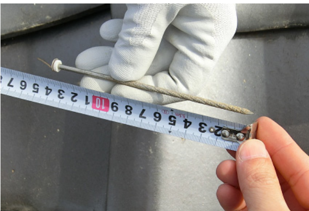
写真 2.8.5 東側棟の棟瓦を緊結するスクリュー釘
