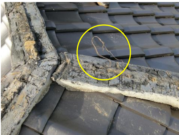
写真 2.8.7 西側棟の棟部に残った緊結線
