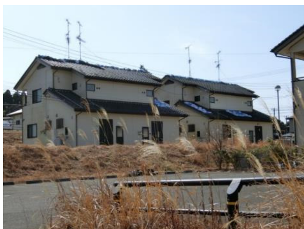
写真 2.9.4 町営住宅の外観と東西方向棟の被害
