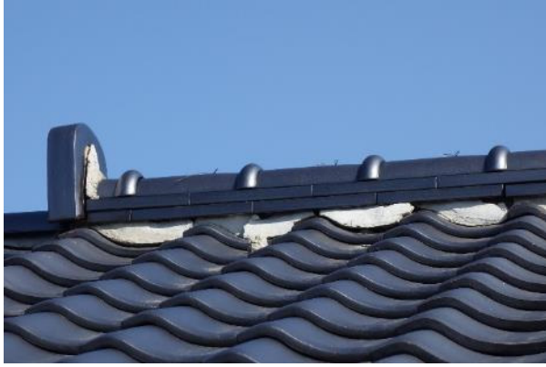
写真 2. 2. 3 棟の面戸漆喰の剥がれ
