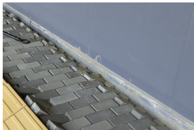
写真 3.3.3 噴砂の可能性を示唆する痕跡
