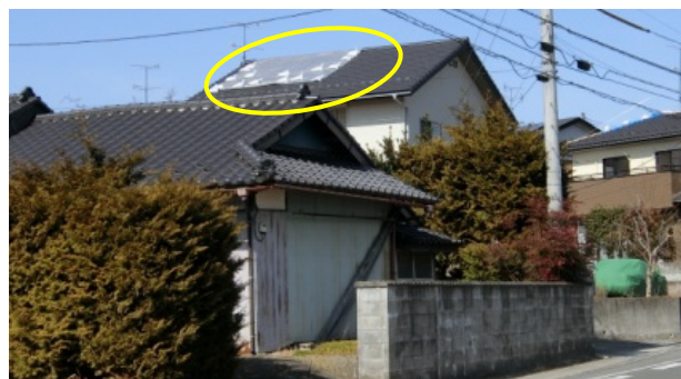
写真 2.9.7 平部に被害を受けた可能性がある住宅
