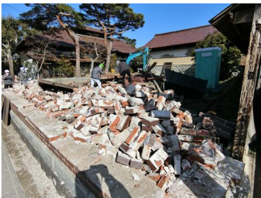
写真 3.2.1 崩壊した煉瓦による組積造の塀
