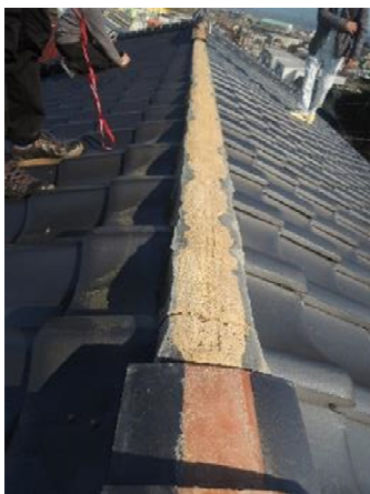
写真 2.5.3 のし瓦等が脱落した範囲の状況
