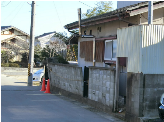
写真 3.2.3 大きく傾いたブロック塀
