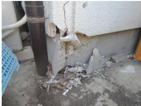
写真 2.1.6 基礎の隅角部の被害
