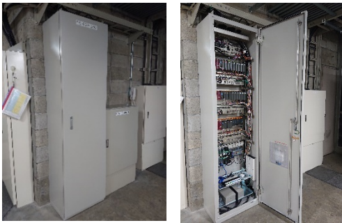
【各実験棟設置リモートステーション(建築研究所工事)】
