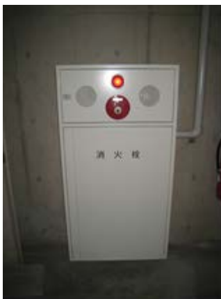
【屋内消火栓外観】
