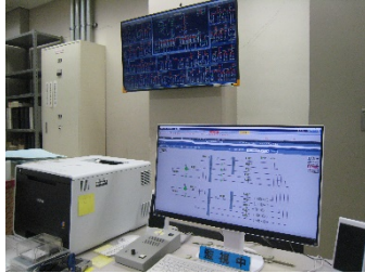
【中央監視制御装置(国土技術政策総合研究所工事)】
