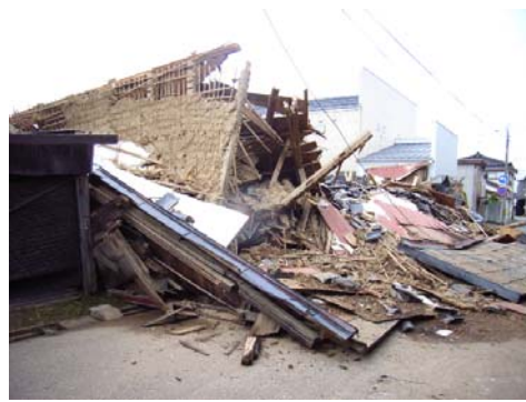
平成19年新潟県中越沖地震被害調査
