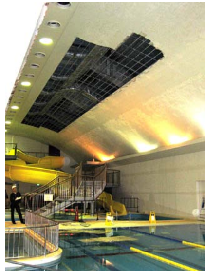
豊田スタジアムスポーツプラザ 屋内プール天井板脱落事故調査
