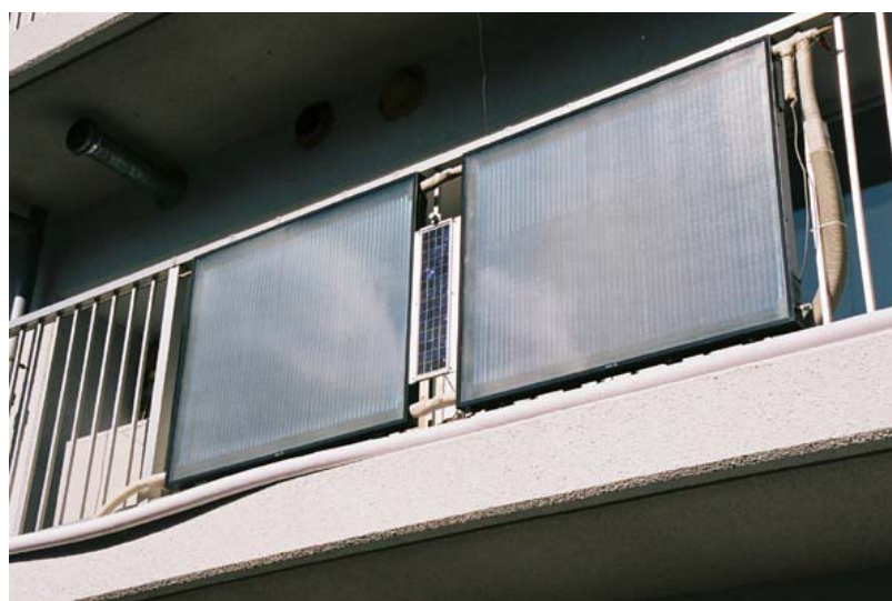
給湯用のソーラーパネルを集合住宅手すりに取り付けた状況
