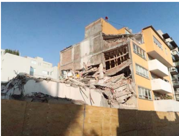
写真-I-1. 2. 2 建築物被害の例
