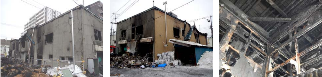
写真-I-1. 2. 1 火災建物の状況
