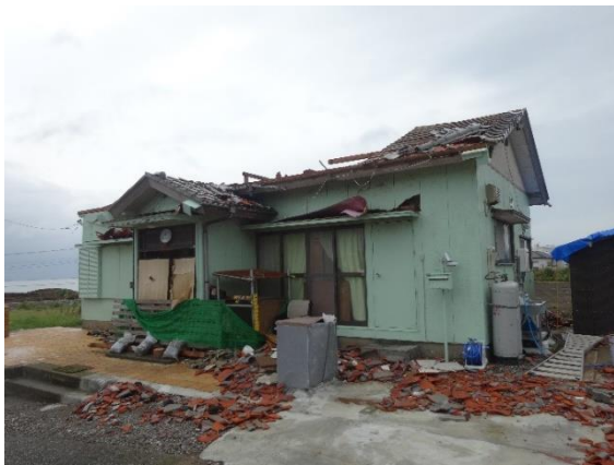
(a) 小屋組が飛散した住宅
