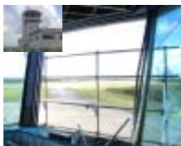
図3 宮古空港管制塔の被害
