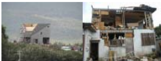
図6 住宅の屋根葺き材・外壁の被害
