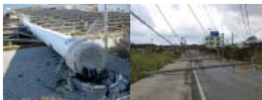
図4 風力発電風車の被害
