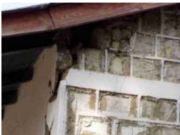
写真 4 0 外壁隅角部の破壊状況
