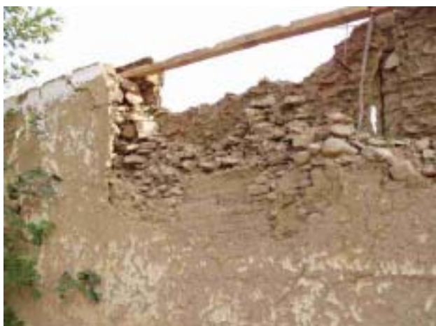
写真54 上部は割石、下部は丸石、中央部にはレンガが使われている。また、その継ぎ目も不整形となっている。
