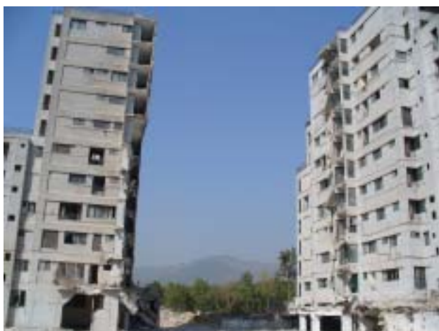
写真29 イスラマバードの被災した高層住宅 住棟の間に建っていた部分が倒壊した
