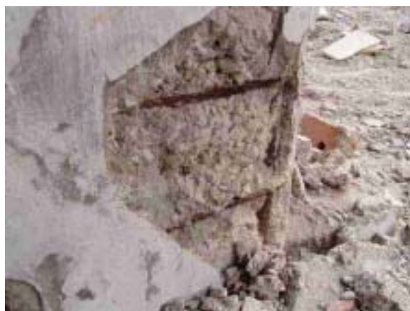
写真38 発錆の進んでいる鉄筋
