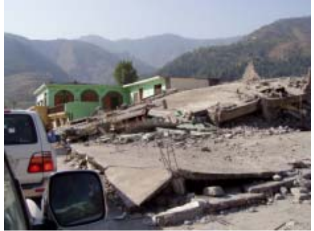
写真15 バラコート 屋根スラブが地面まで崩落している
