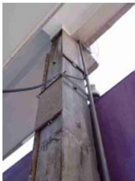
写真3 5 柱の化粧材(自然石板)の落下
