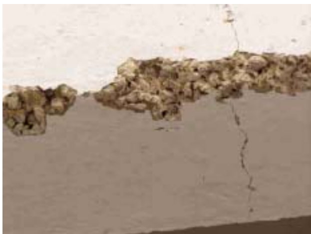
写真37 コンクリート内部の空隙
