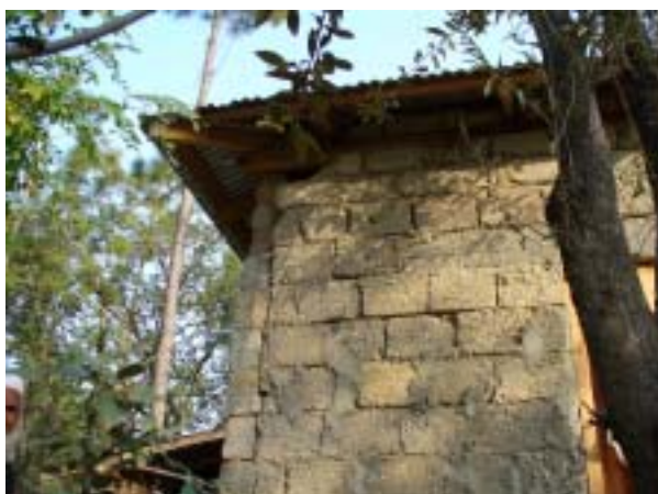
写真60 壁隅角部のひび割れと上部ブロックの脱落
