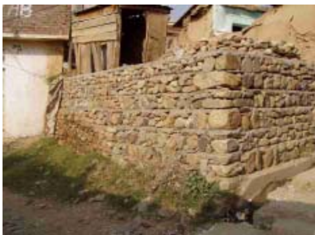
写真62 「石造住宅」の筋向かいにあった建築中の壁 (一定間隔に水平のコンクリート帯を配置している)
