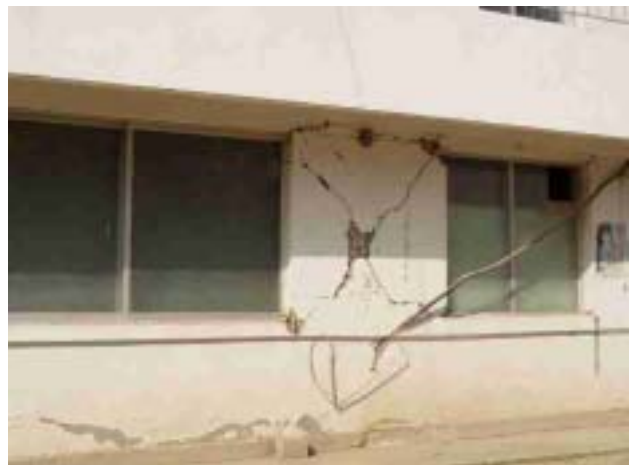
写真26 病院新館1階 壁面に剪断によると思われるクラックが入っている
