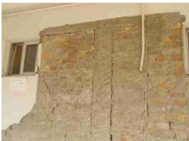
写真28 病院本館1階の柱とレンガ壁 クラックが入った部分の仕上げを調査のためにはつっている
