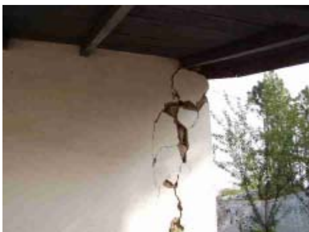
写真 4 1 外壁隅角部の破壊状況
