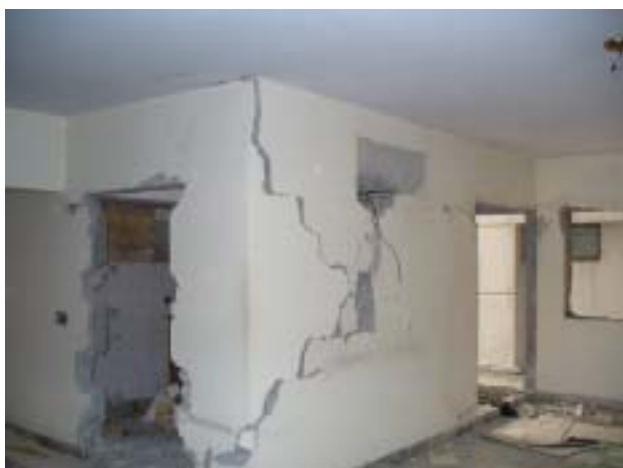
写真3 2 倒壊を免れた住棟の1階住戸内部
