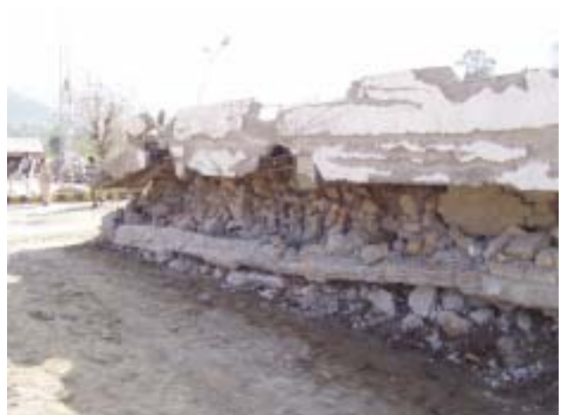
写真17 壁の崩壊状況
