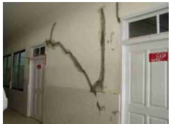
写真27 病院新館1階廊下(クラックはモルタルで補修されており、目立つ状態になっている)
