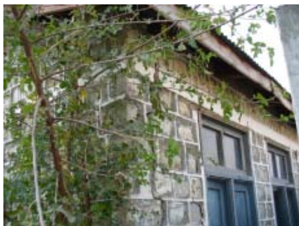
写真 4 3 州立小学校壁隅角部のひび割れ
