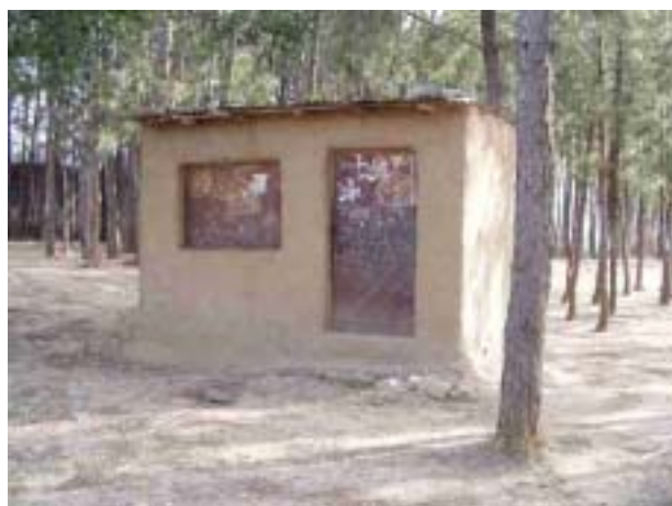
写真61 「ア州立小学校」の敷地内のアドベの小屋。クラックも生じていなかった。
