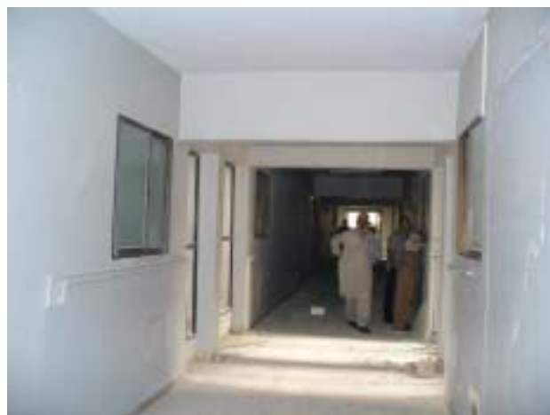
写真31 倒壊を免れた住棟の1階廊下
