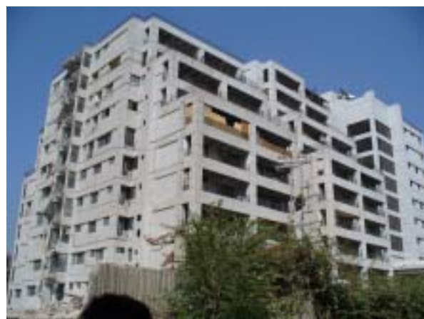
写真30 倒壊を免れた住棟(3棟) (写真29の右側に見える住棟)
