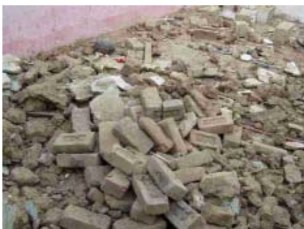
写真56 室内に崩落、散在していたブロック （壁の上部に使われていたと思われる）
