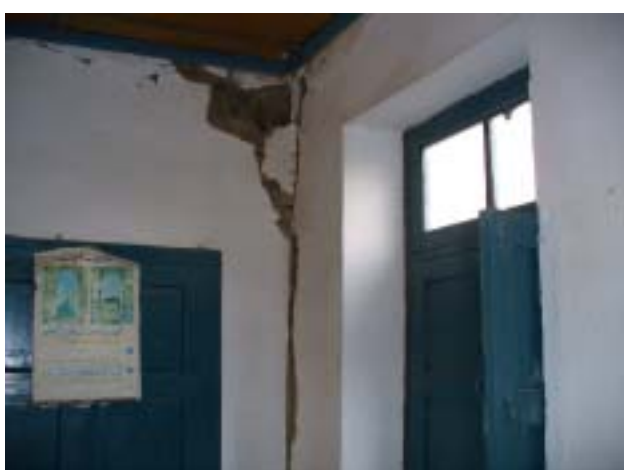
写真 4 2 隅角部のクラック(室内)
