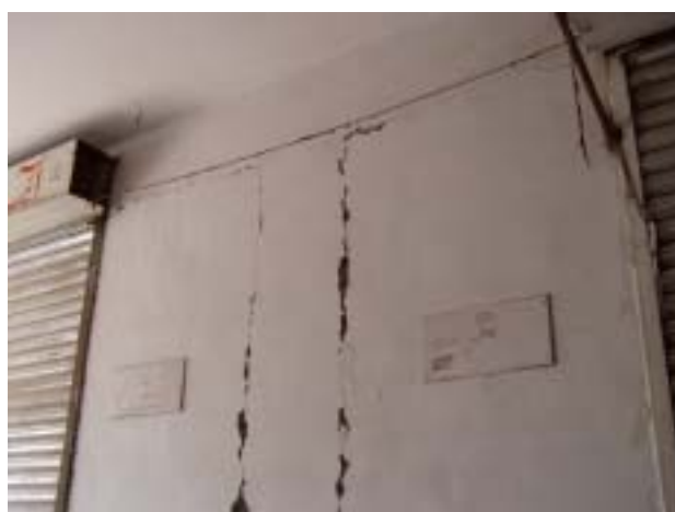
写真22 写真19の建物の内部 構造材（柱、梁）と間仕切り壁との間にクラックが入っている 壁自体のクラックは見あたらない
