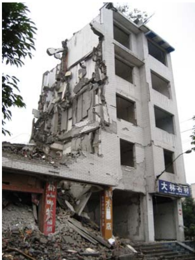
写真7 2階以上の崩壊
