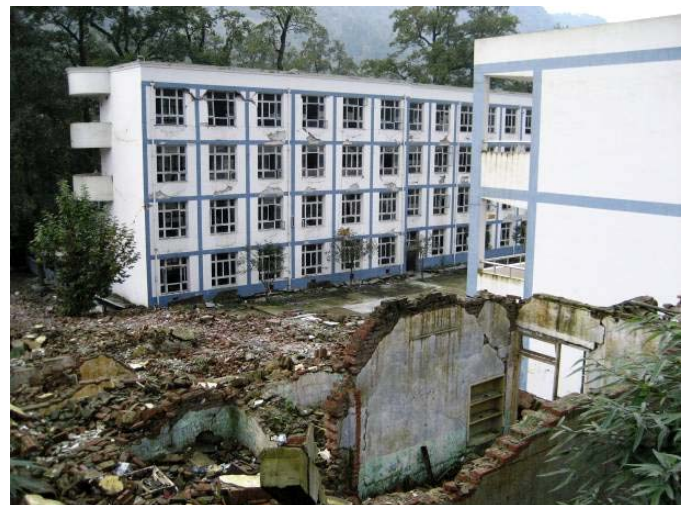
写真14 倒壊した組積造建物（手前）
