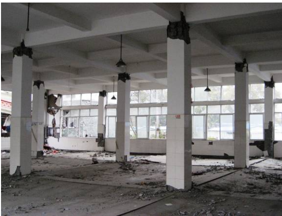
写真22 柱頭・柱脚の曲げ破壊 (映秀)
