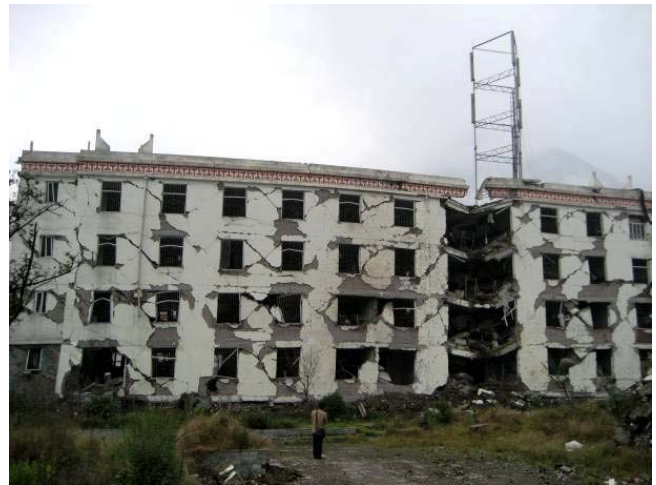
写真 3 1 階が完全に崩壊した学生寮（映秀）
