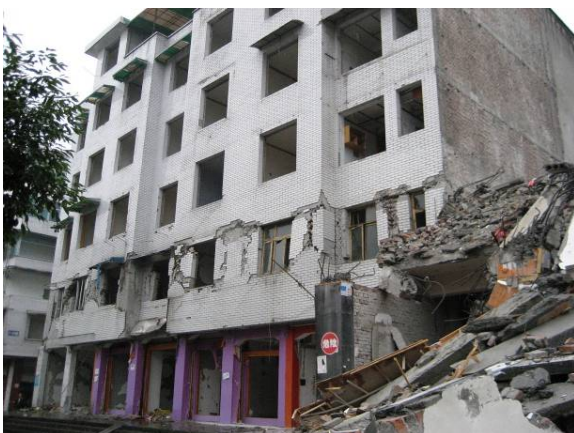
写真8 2階に被害が集中した建築物
