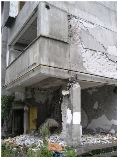
写真 16 下階壁抜け部分で大きく損傷した 1階の柱（都江堰）
