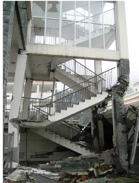
写真24 階段が取り付けく柱の破壊(映秀)
