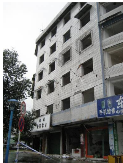
写真 29 非構造壁の破壊（漢旺）
