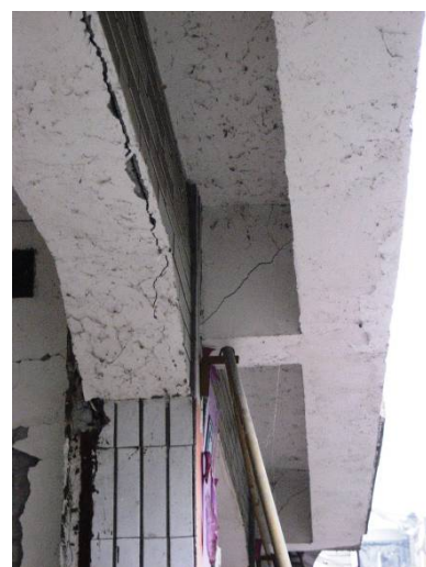
写真 19 1階柱と2階柱をつなぐ梁のせん断破壊（都江堰）
