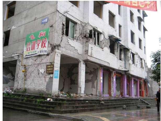
写真 17 2階に被害が集中した建築物（都江堰）
