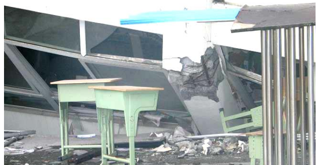
写真2 1階柱頭の曲げ破壊（映秀）
