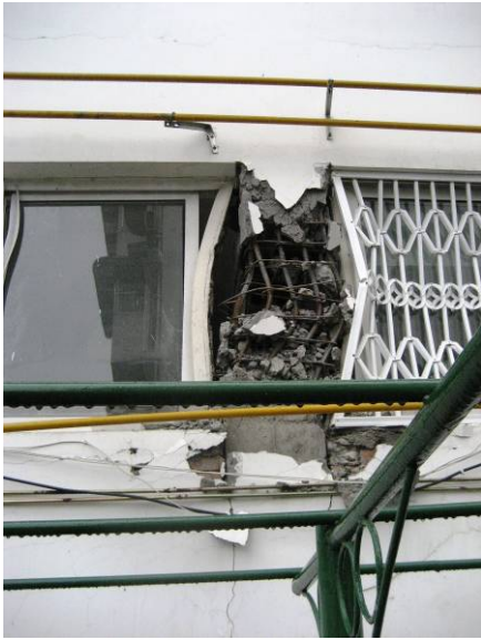
写真20 短柱のせん断破壊 (都江堰)
