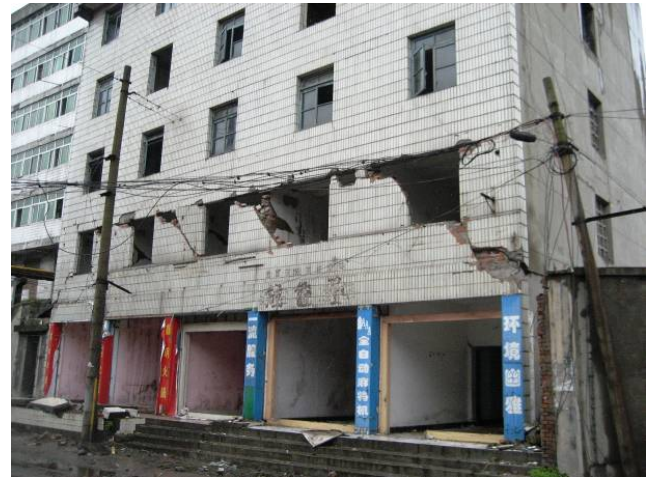
写真10 2階に被害が集中した建築物
