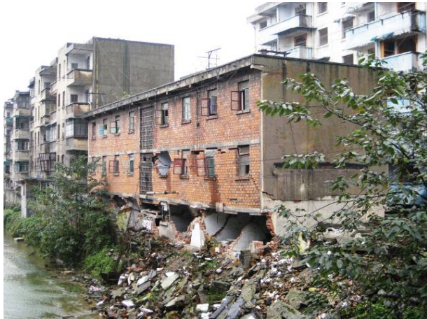
写真 15 1階が大きく破壊された組積造（漢旺）
