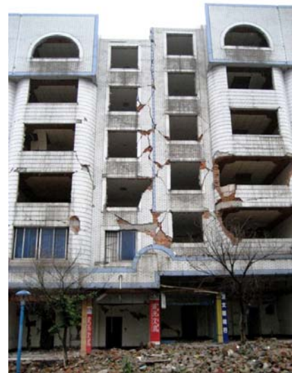
写真12 全階に被害が生じた枠組み組積造建築物
