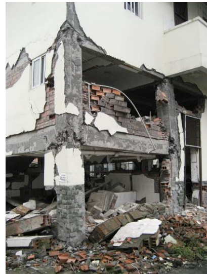
写真23 柱頭・柱脚の曲げ破壊 (映秀)
