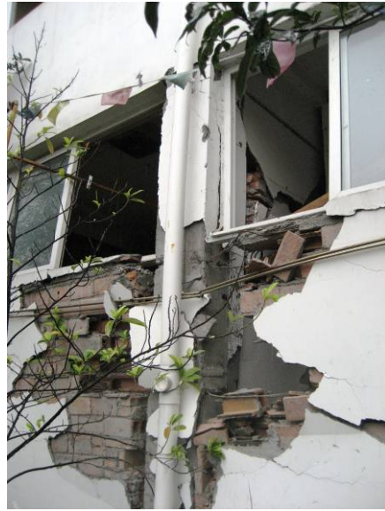
写真21 腰壁が先に壊れて短柱とはならなかった柱 (写真20と同じ建物)
