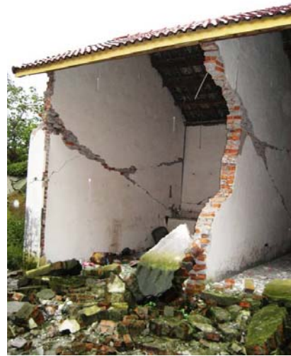
写真 27 組積壁の面外方向への破壊・転倒（漢旺）
