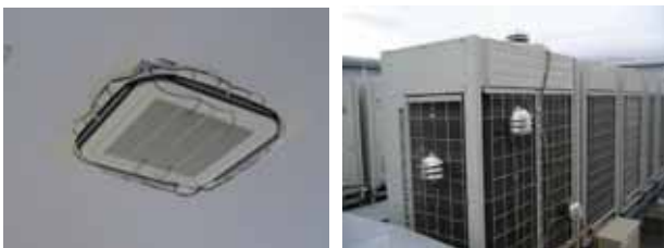
図4 個別分散型空調システムの実効効率計測の様子
