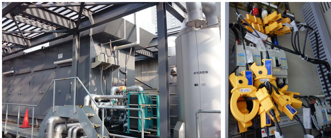
写真：実測対象CGSと電力測定の状態
