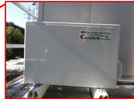
地中熱利用HP室外機
