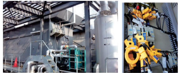
図19 実測対象のコージェネレーションと電力測定の状態
