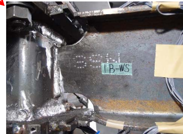
損傷状況 (1B西)
