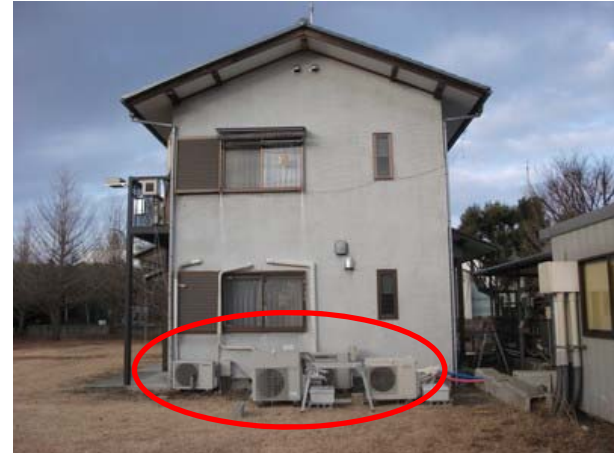
室外機設置状況
