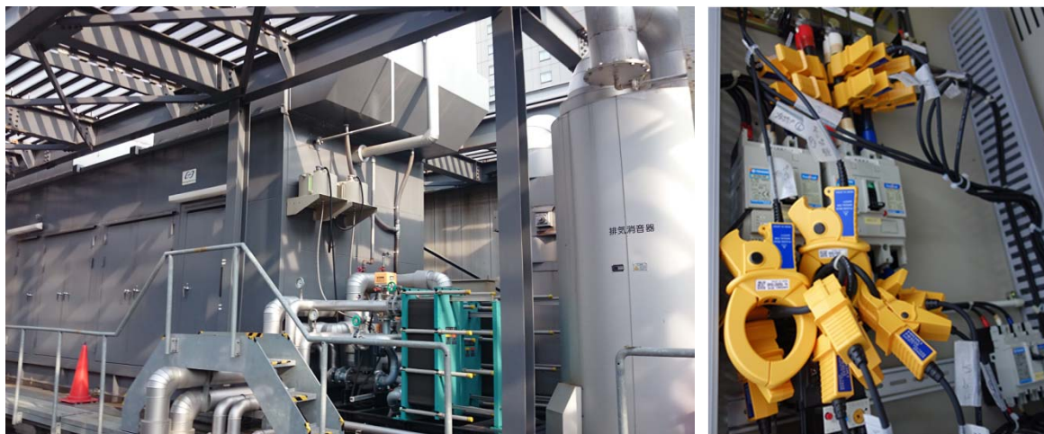
写真：実測対象CGSと電力測定の状態
