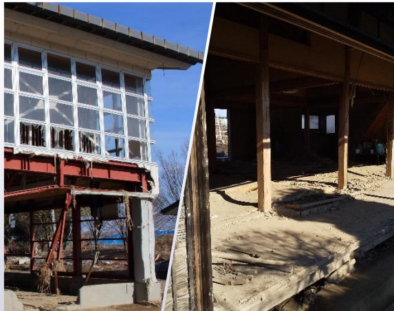
千曲川破堤地点付近の被災建物
