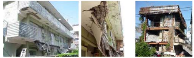
図2 外壁の剥落などにより危害が生じるおそれがある例 3)
