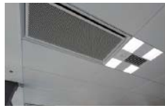
空調立上り時に稼働する ペリメータのチルドビーム
