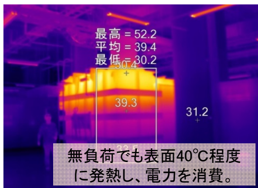
特高変圧器の表面温度
