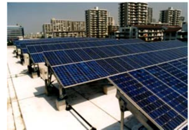
既設の太陽光発電設備
