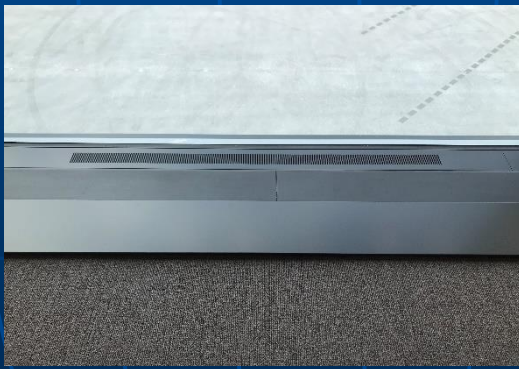
自然給気口（自動制御）
