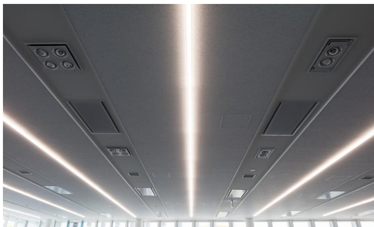
タスクアンビエント空調・DALI照明
